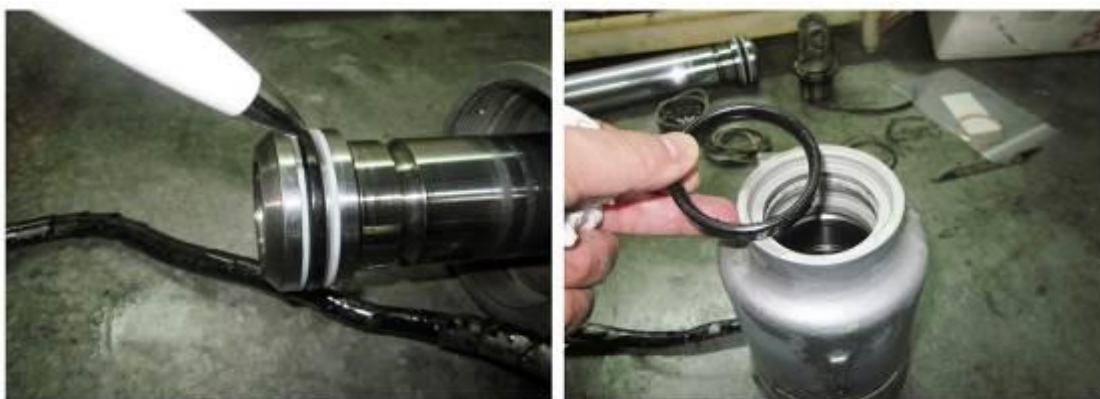
Fig. 11: Detalle del desarme y ubicación de los sellos sospechados de fallo.
