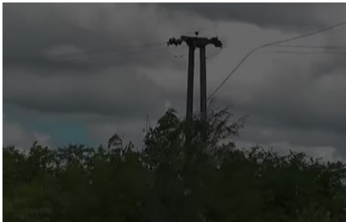
Figura 4. Instalación de alta tensión con la cual colisionó la aeronave
