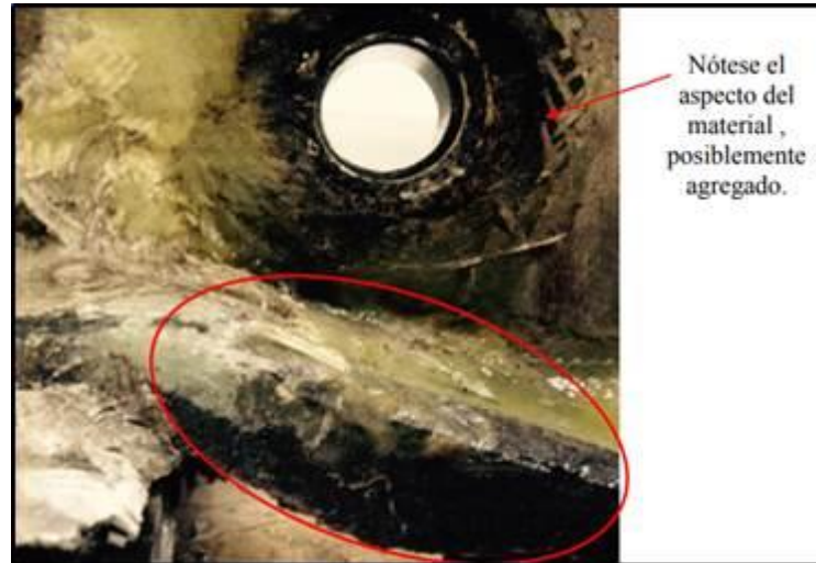
Figura 16. Resina que fluyó (aspecto brillante) en la platabanda inferior
