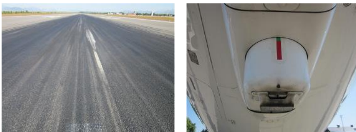
Figura 6. Marcas en la pista y el patín de cola de la aeronave producto del tail strike
