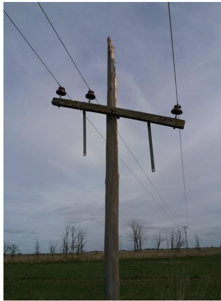
Figura 2. Poste de electricidad impactado
