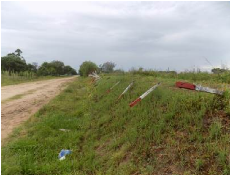
Figura 2. Alambrado perimetral ubicado en la cabecera de la pista 21
