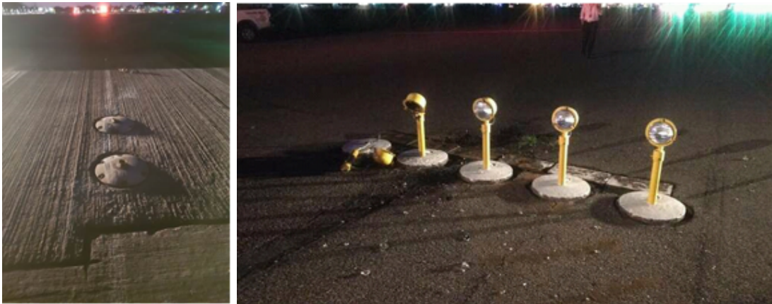
Figura 2. Luces de pista dañadas
