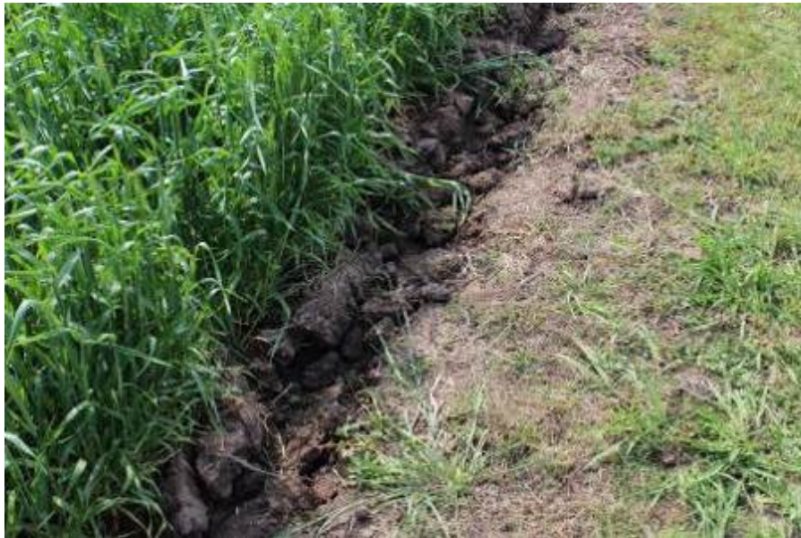
Figura 6. Detalle de la condición de la banquina irregularidades por cableado enterrado
