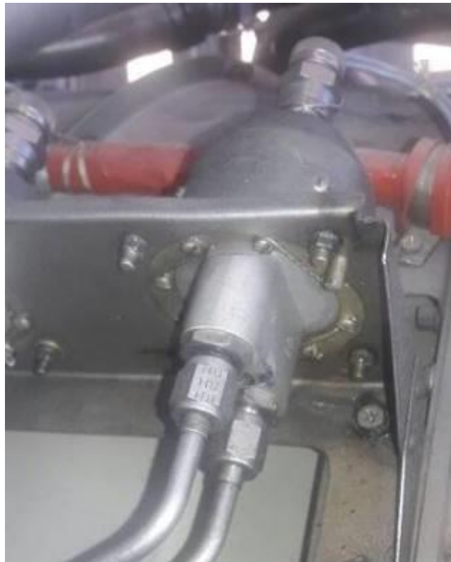
Figura 5. Switch de presión con sus cañerías conectadas
