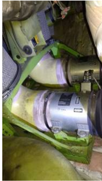
Figura 3. Ventiladores de recirculación de aire
