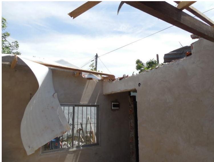
Figura 3. Daños en la vivienda
