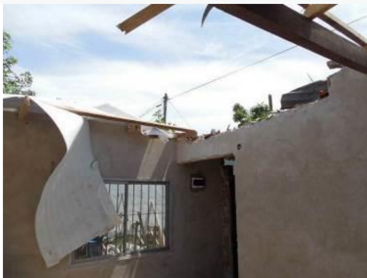
Figura 3. Daños en la vivienda
