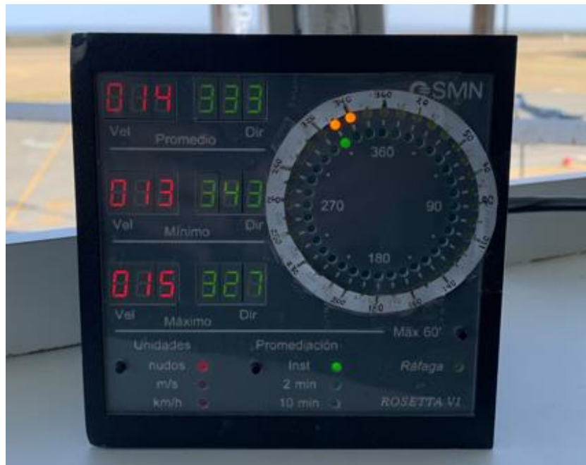
Figura 17. Anemómetro instalado en la torre de vuelo de San Luis. Fuente: investigación JST
