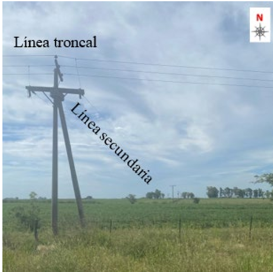
Figura 3. Intersección de línea troncal y tendido secundario. Fuente: investigación JST
