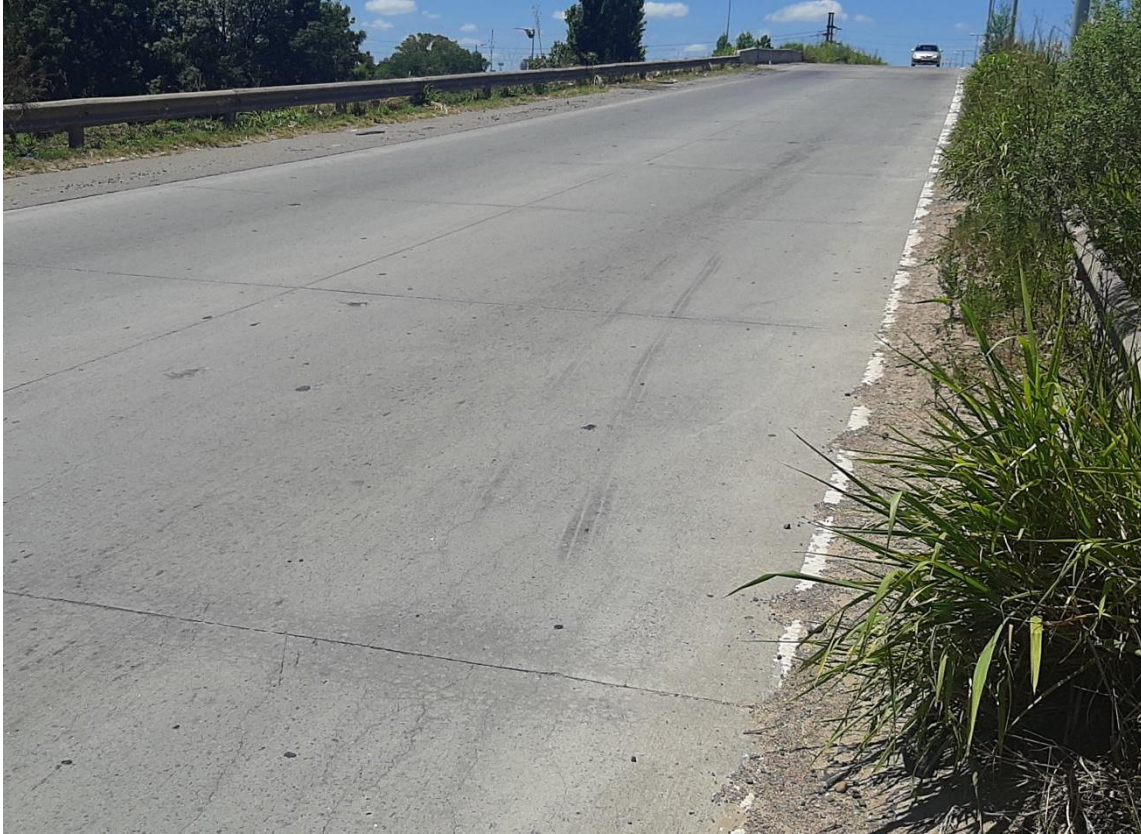
Figura 26. Marcas de caucho sobre la calzada por los neumáticos de la cisterna. Fuente: JST, 2021
