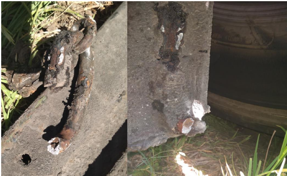
Figura 8. Anclaje y eslabón de cadena fracturados. Fuente: JST, 2021
