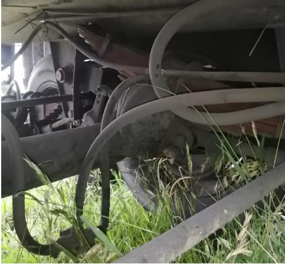
Figura 50. Sistema de freno, tuberías y válvula sin fijación. Fuente: JST, 2021
