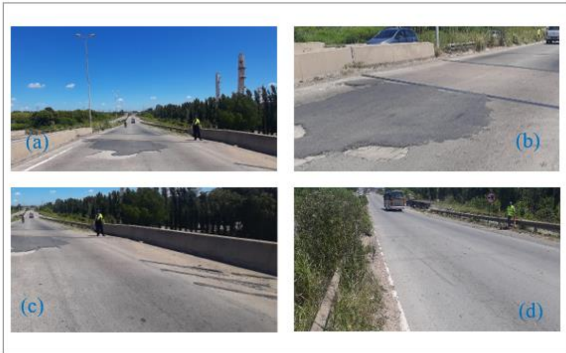
Figura 55. Imágenes representativas de la calzada ascendente con sentido hacia Zárate: (a) imagen de peladura en capa de rodadura cubierta con tratamiento de asfalto; (b) imagen peladura en capa de rodadura donde se observa el armado de acero; (c) imagen de rodilladas de asfalto en banquina externa; (d) imagen banquina interna con montículo de tierra y pasto invadiendo la banquina. Fuente: JST, 2021.
