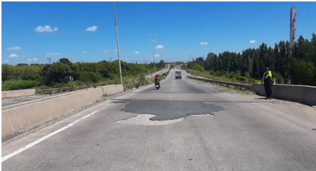
Figura 13. Fotografía de bache en la calzada. Fuente: JST, 2021
