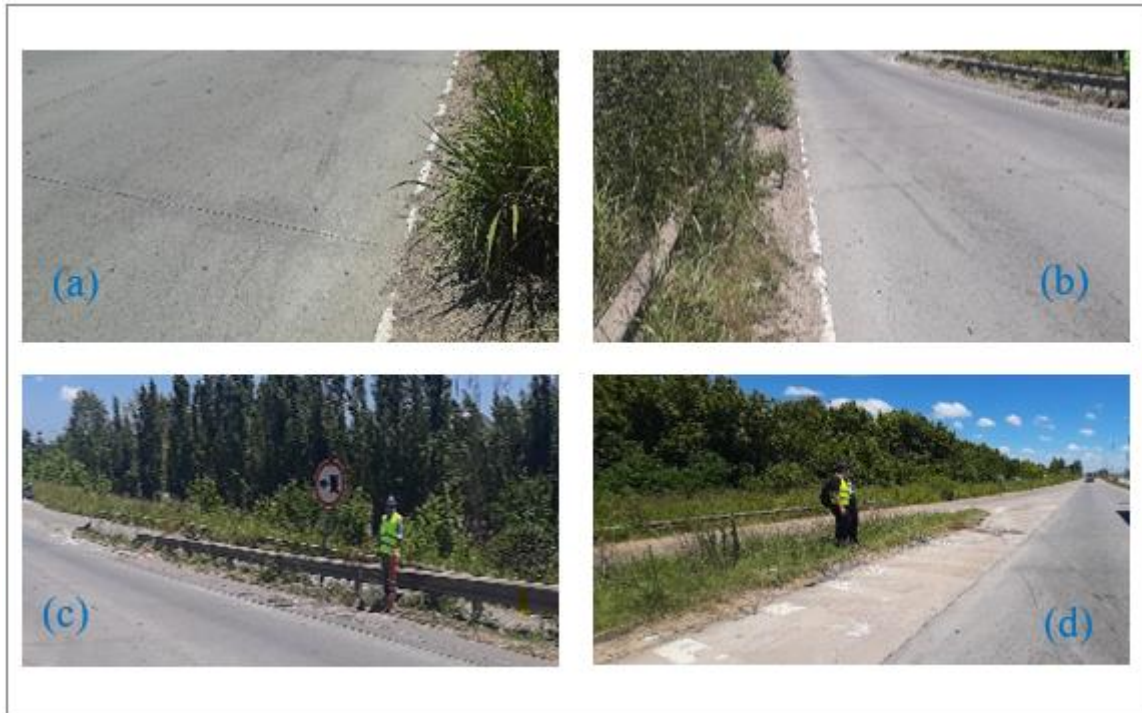
Figura 57. Imágenes representativas de la señalización: (a) imagen de calzada ascendente con línea de borde de carril desgastada y con poca visibilidad; (b) imagen de calzada ascendente donde no se observa línea divisora de carril (completamente despintada); (c) imagen de calzada ascendente del carril derecho con señalización vertical de circulación de tránsito pesado por carril extremo derecho; (d) imagen de calzada descendente con señalización horizontal canalizadora del tránsito en la rama de salida despintada y poco visible. Fuente: JST, 2021
