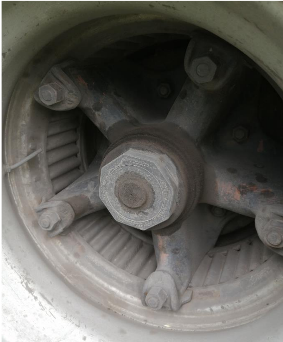
Figura 51. Pérdida de lubricante. Fuente: JST, 2021
