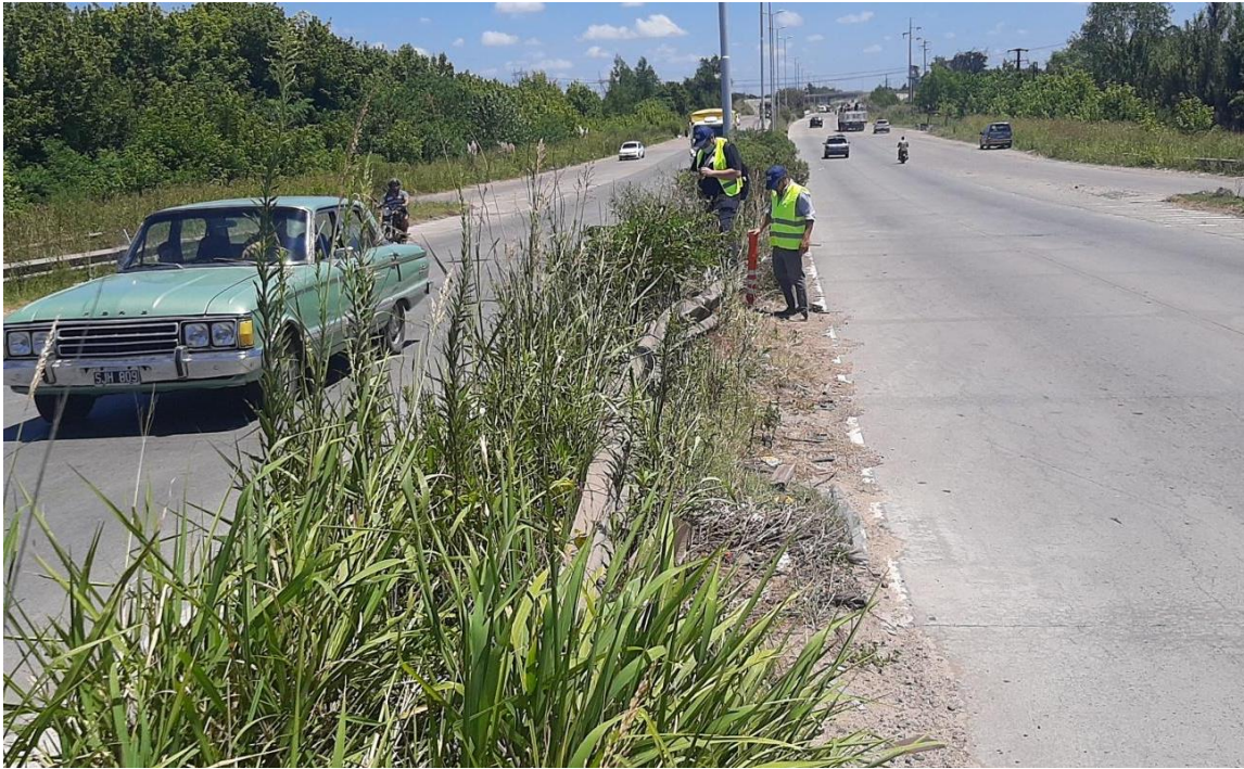
Figura 27. Deformación plástica de la barrera semirrígida metálica. Fuente: JST, 2021.
