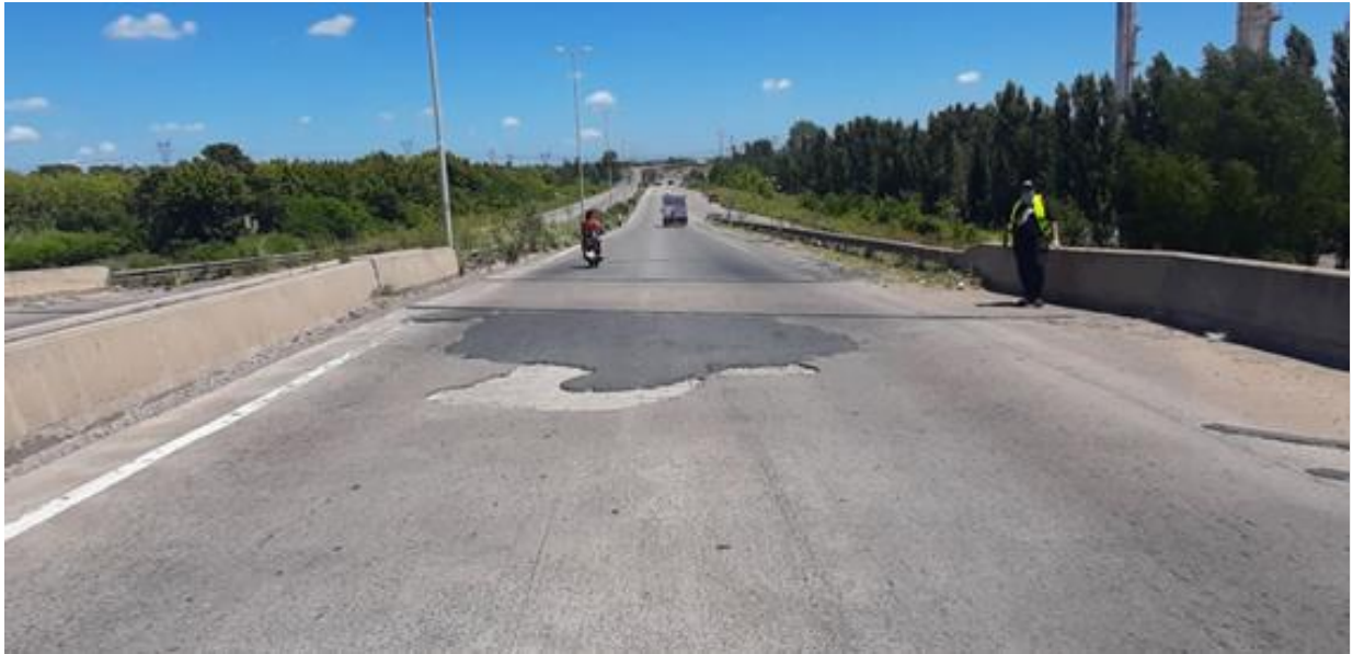
Figura 23. Bache en la calzada a la salida del puente. Fuente: JST, 2021
