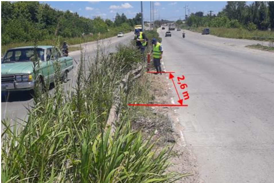
Figura 10. Deformación de 2,6 m de la barrera de contención lateral metálica. Fuente: JST, 2021
