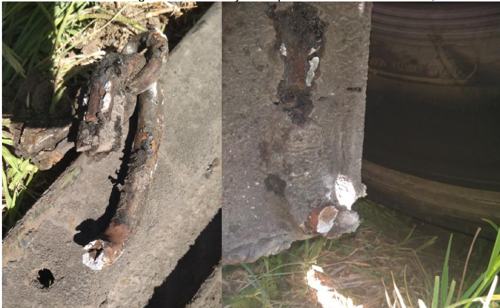
Figura 47. Anclaje y eslabón de cadena fracturados. Fuente: JST, 2021
