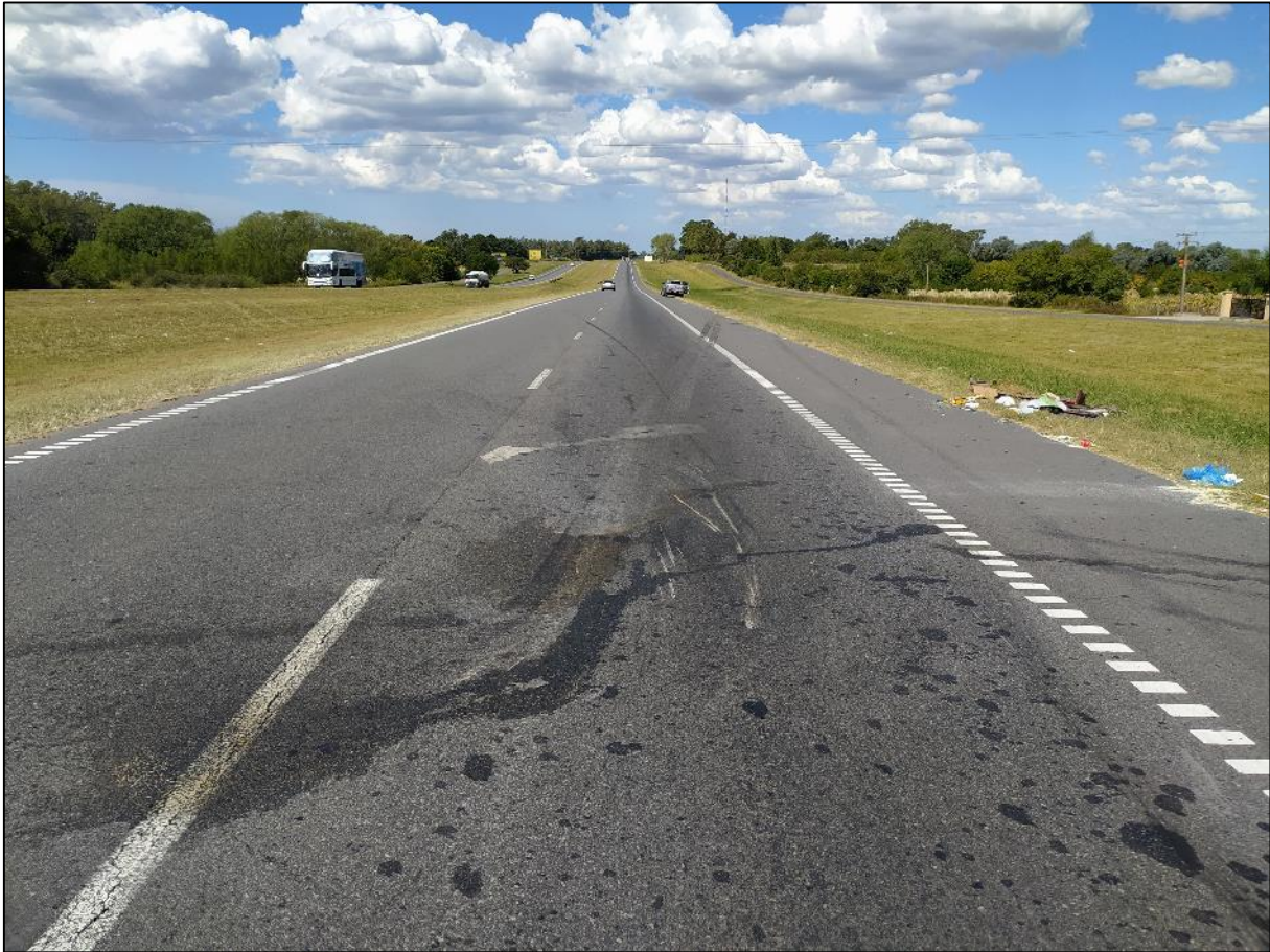
Figura 7. Fotografía del sentido de circulación hacia CABA, donde se observan huellas y vestigios correspondientes a los vehículos 1 y 3. Fuente: JST, 2021.
