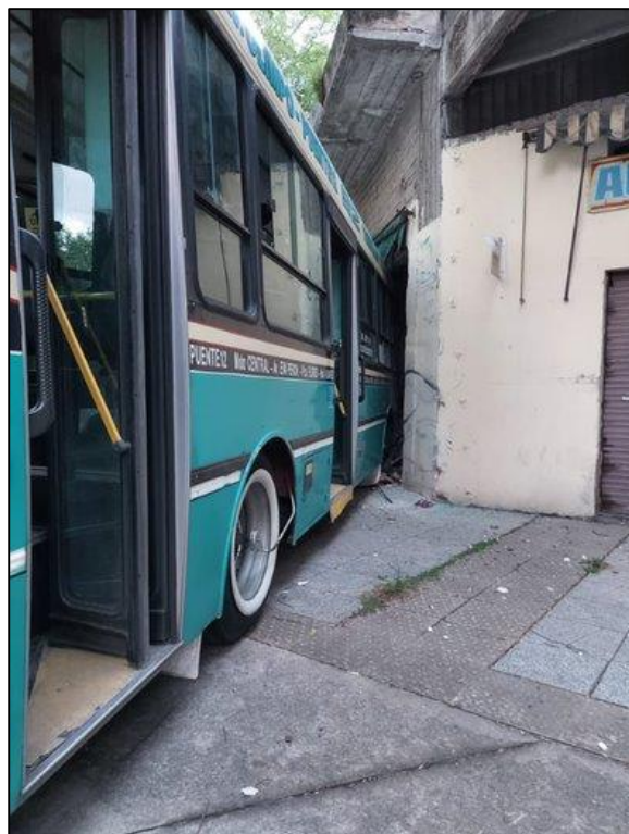
Figura 7. Daños en fachada de propiedad privada. Fuente: JST, 2021.
