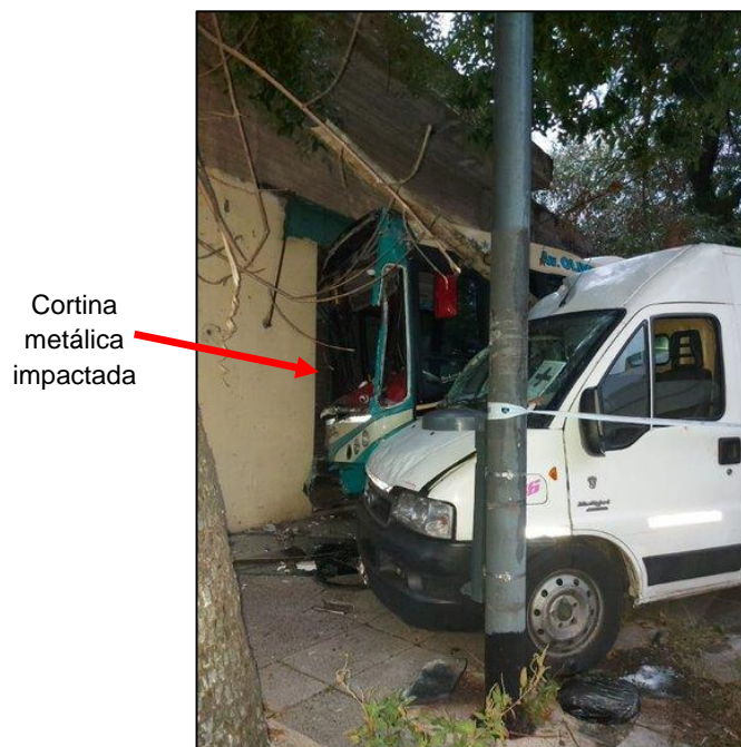
Figura 8. Daños en la fachada de la construcción. Fuente: JST, 2021.
