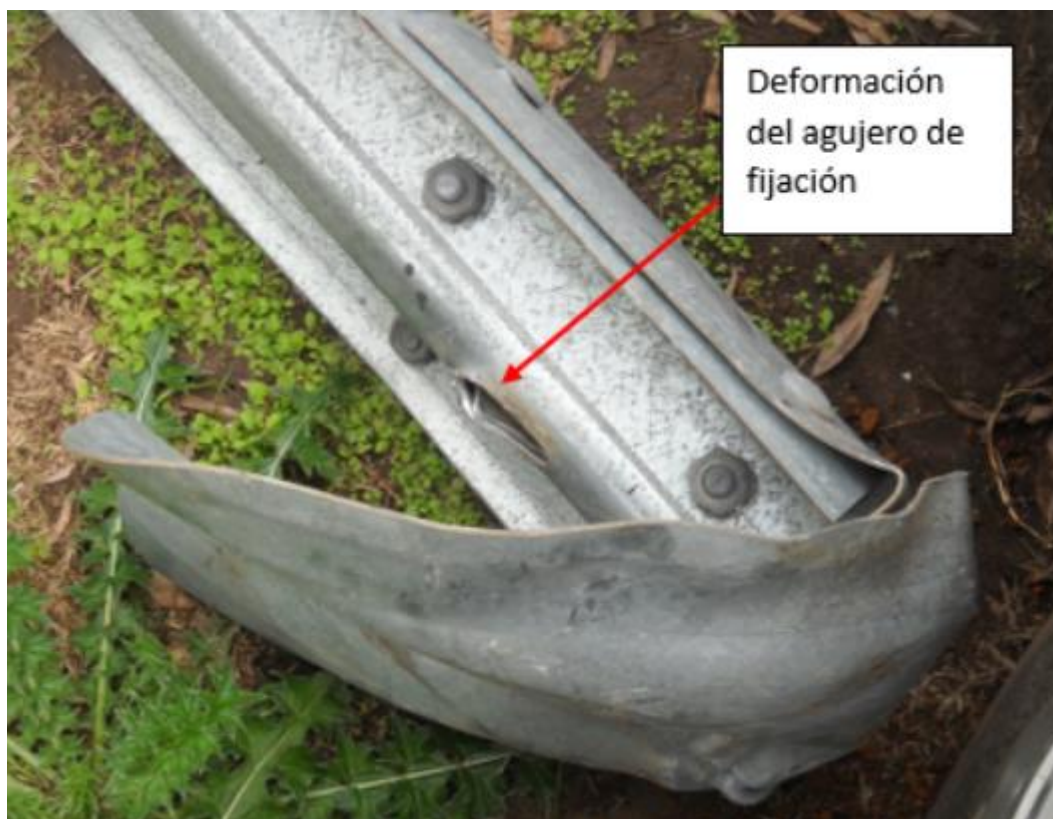
Figura 13. Deformación en el agujero de fijación de la viga con el primer poste. Fuente: JST, 2021.
