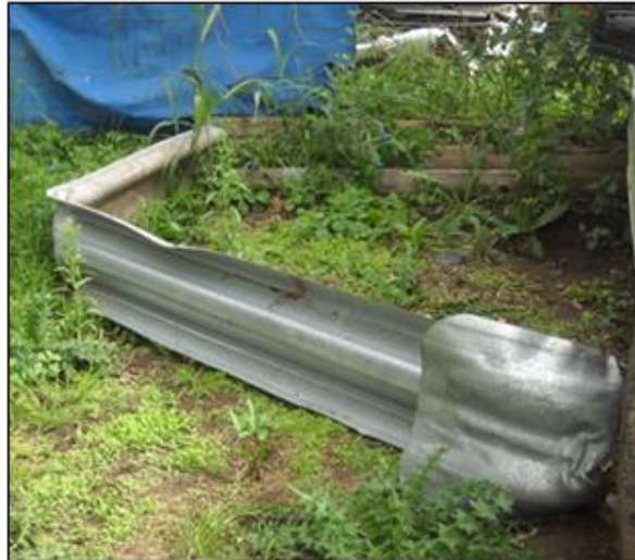
Figura 7. Fotografía de viga deformada, correspondiente al extremo terminal de la barrera de contención impactada. Fuente: JST, 2021.
