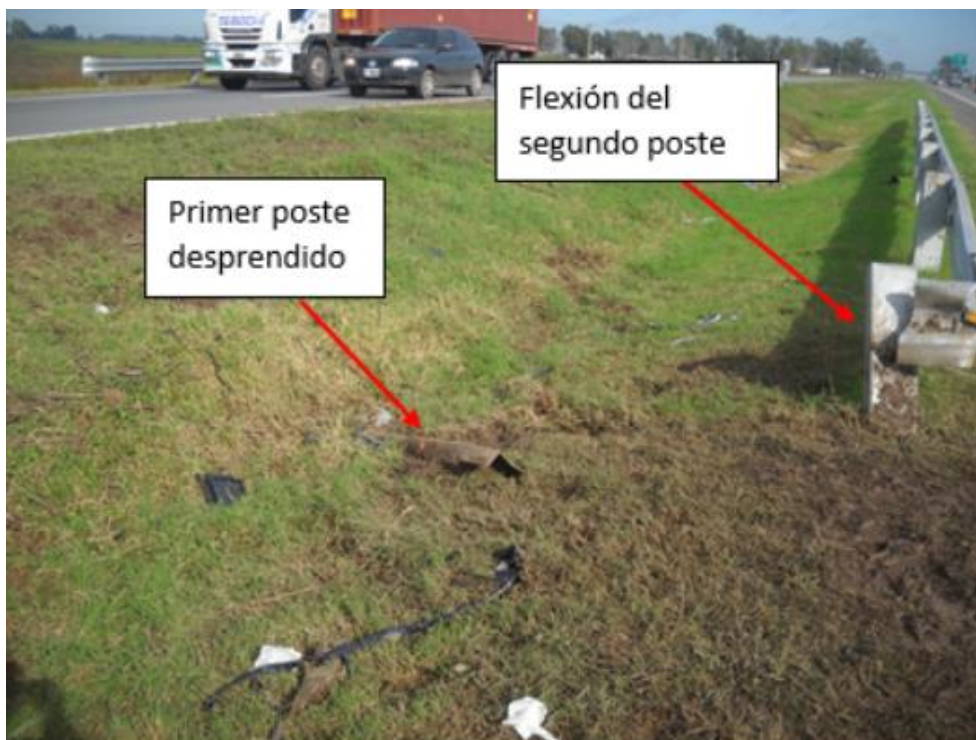
Figura 11. Rastros de la barrera en el lugar del hecho. Fuente: JST, 2021.
