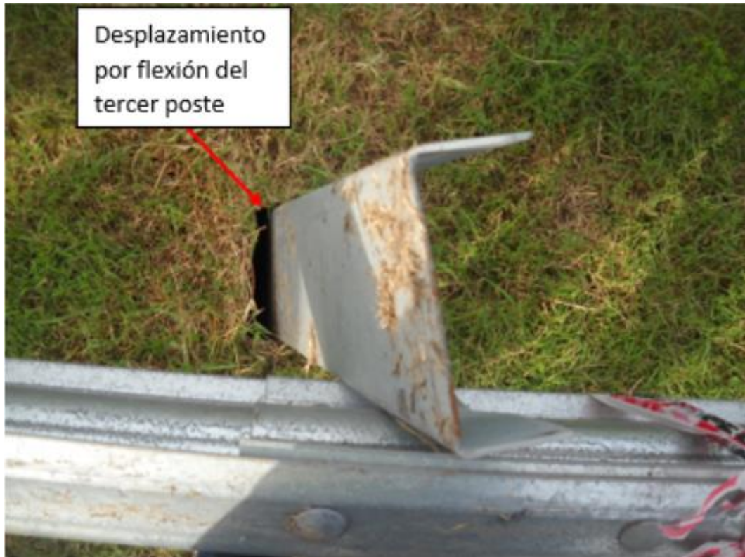
Figura 16. Daño en el tercer poste. Fuente: JST, 2021.
