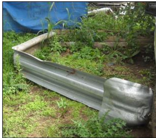
Figura 6. Extremo terminal de la barrera de contención impactada
