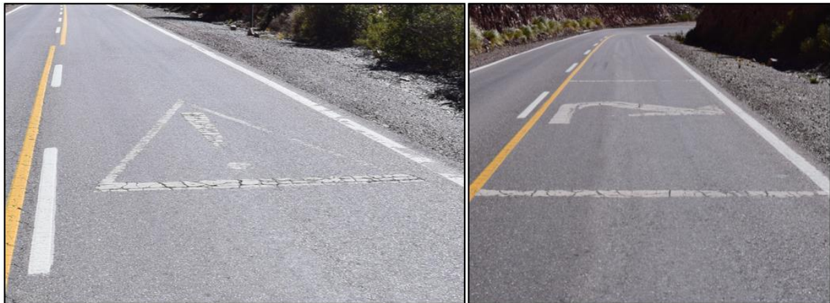
Figura 14. Señalización horizontal presente en zona previa al lugar del suceso
