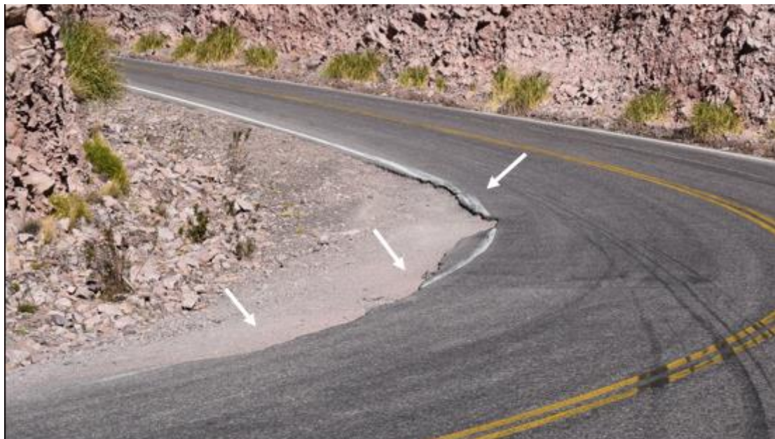
Figura 12. Desprendimiento de material de la calzada en el sector interno de la curva
