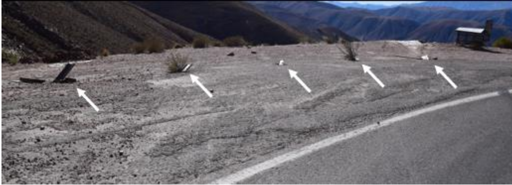
Figura 3. Sector del guardarraíl desprendido con los cinco postes que lo sostenían torcidos por el impacto junto a la mesa de información
