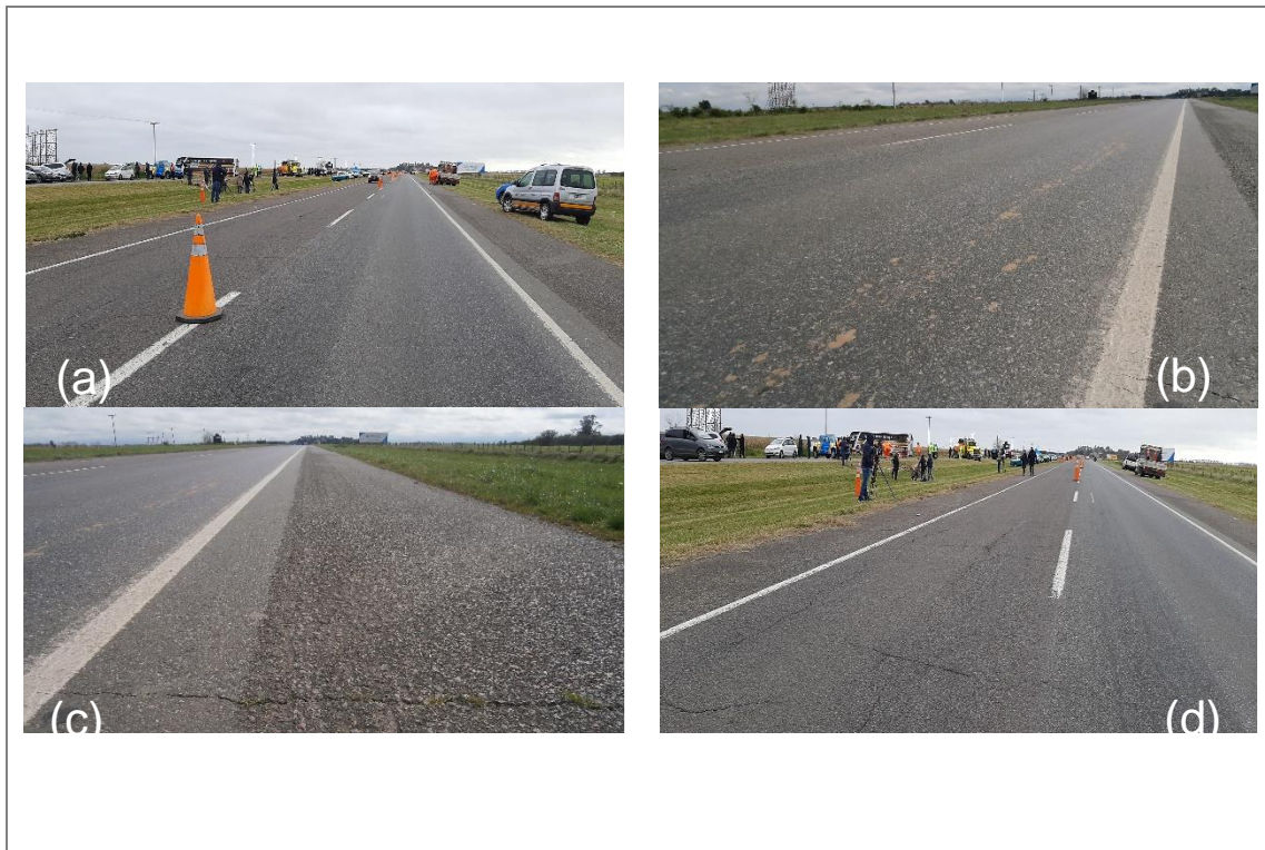
Figura 28. Principales fallas observadas en la calzada
