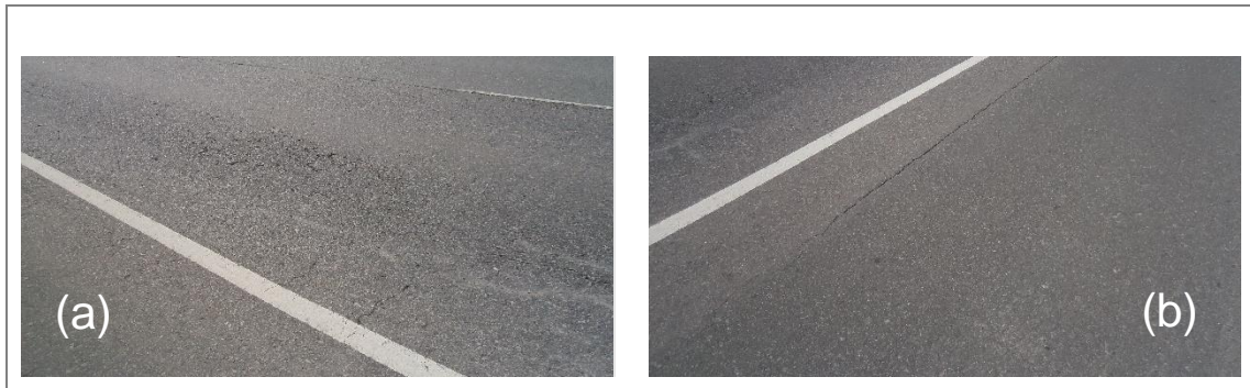
Figura 27. Fisuras de la calzada ascendente
