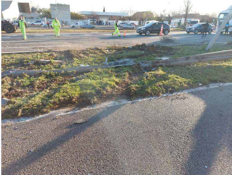
Figura 15. Fotografía de los daños en la barrera de contención metálica semiflexible. Fuente: JST, 2021.
