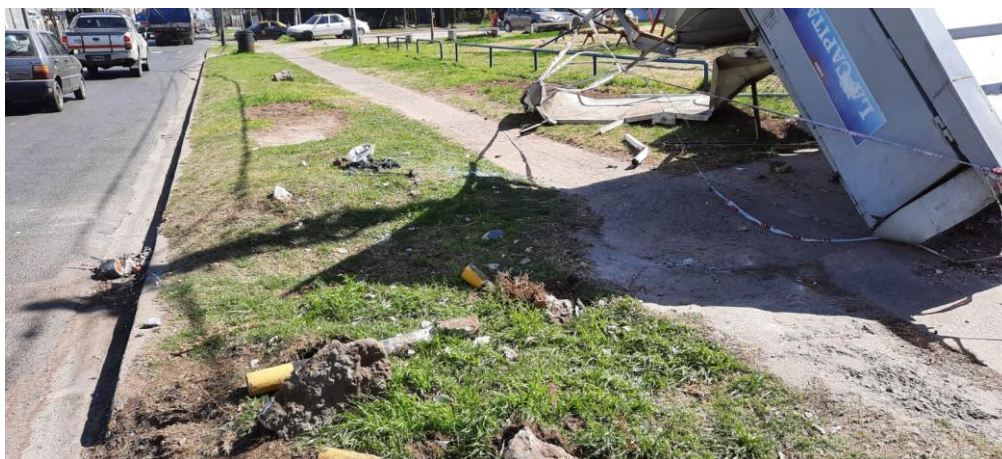
Figura 4. Daños en la vía. Fuente: JST.
