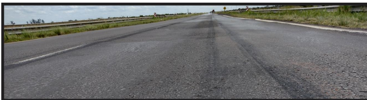
Figura 9. Rastros de neumático detectados sobre el carril derecho de la banda de circulación sureste identificados como A. Además, se puede apreciar que la impronta fue patentizada en un trayecto de la vía donde la calzada presentó ahuellamiento. Fuente: JST, 2021.
