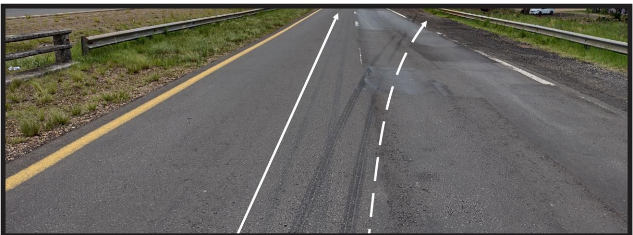
Figura 11. Fotografía que muestra el sector de la calzada donde se observaron las marcas de neumático identificadas como C, señaladas mediante línea continua junto a las marcas de derrape identificadas como B, indicadas mediante línea discontinua. Fuente: JST, 2021.
