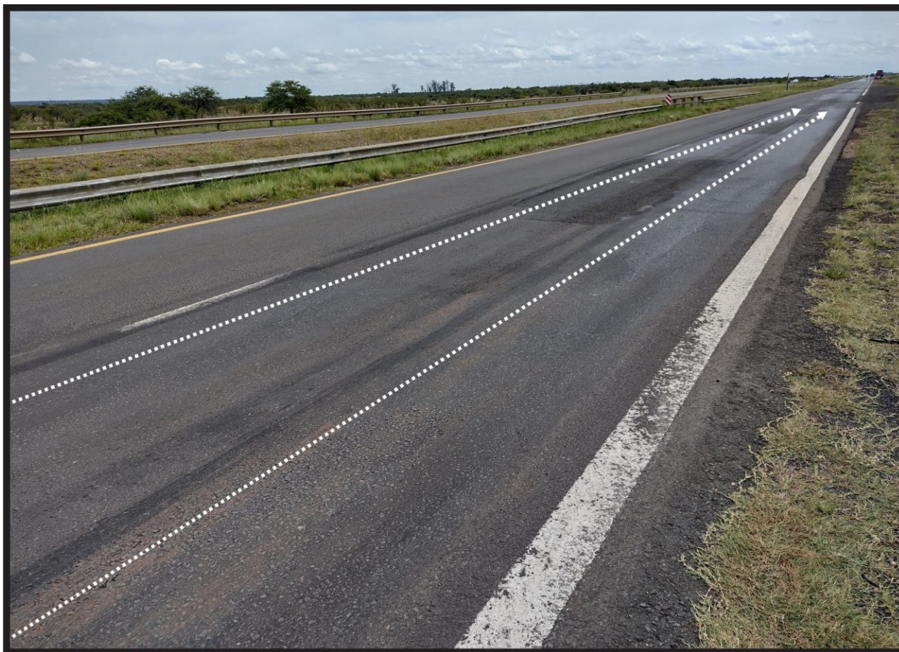
Figura 8. Rastros de neumático detectados sobre el carril derecho de la banda de circulación sureste de la autovía, identificada como A. Fuente: JST, 2021.
