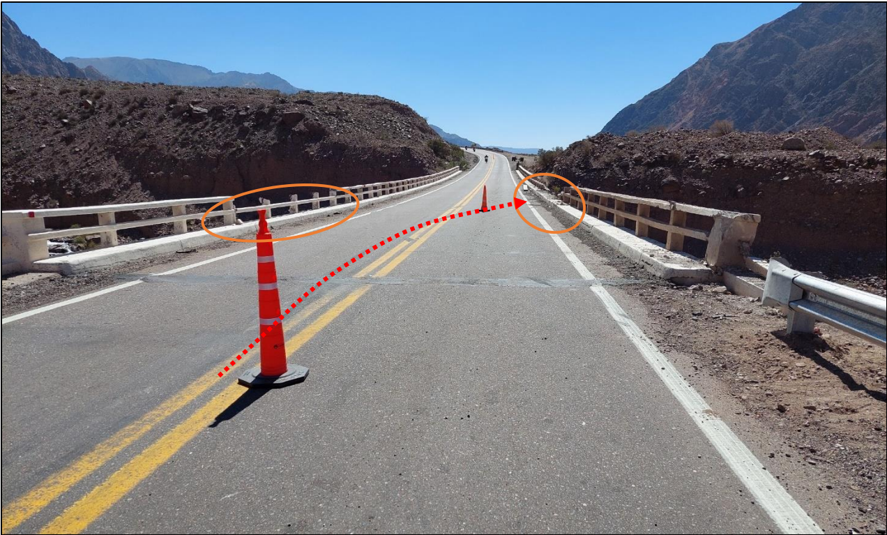
Figura 8. Inicio del puente. Comienzo de impronta neumática sobre línea amarilla izquierda (oeste) que avanza curvilíneamente sobre el carril opuesto. Se observan dentro de las figuras circulares las roturas de los parapetos. A la derecha de la imagen, el lugar del despeñamiento. Fuente: JST, 2022
