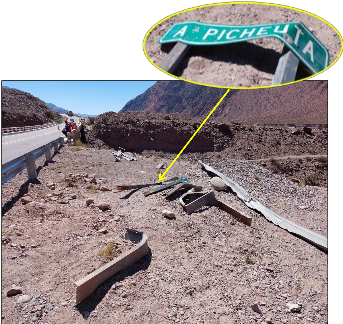
Figura 7. Espacio terroso sobre el costado este, previo al inicio del puente. Se observan restos de barreras laterales flex beam y cartel informativo deformado con la leyenda "A° Picheuta", con sus bases astilladas por arrancamiento. Fuente: JST, 2022
