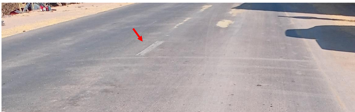
Figura 4. Demarcación horizontal sobre el centro de la calzada. Fuente: JST, 2022
