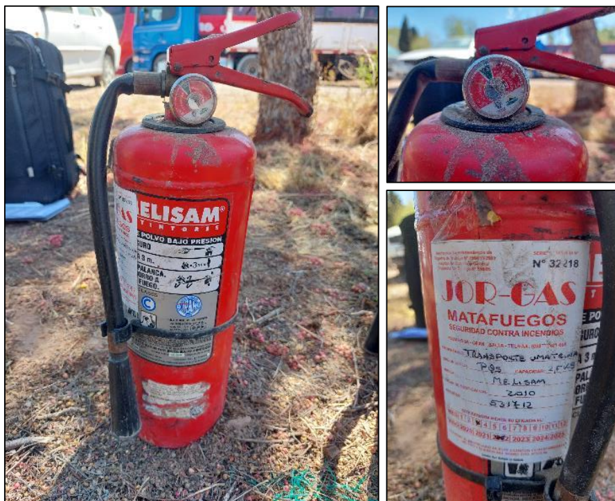
Figura 28. Fotografías de extintor para recargar (uno de tres) del Vehículo 1: marca MELISAM, clase C, de 2,5 kg, Mantenimiento JOR-GAS, Serie B, Tarjeta N.º 32218. Pierde eficacia el 3/2022. Fuente: JST, 2022
