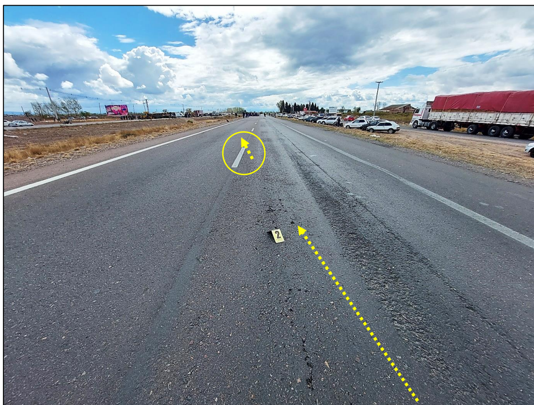
Figura 8. Fin de la huella de derrape e impronta neumática sobre la línea blanca discontinua, con dirección hacia el suroeste. Al mismo tiempo, se observan fallas sobre el pavimento; ahuellamiento y fisuras, situadas sobre el carril norte (derecho de la imagen). Fuente: JST, 2022
