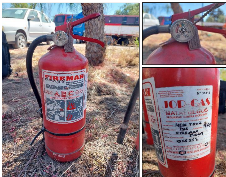
Figura 29. Fotografías de extintor para recargar (dos de tres) del Vehículo 1: marca FIREMAN, clase A, B y C, de 4 kg, Mantenimiento JOR-GAS, Serie B, Tarjeta N.º 31418. Pierde eficacia el 11/2021. Fuente: JST, 2022
