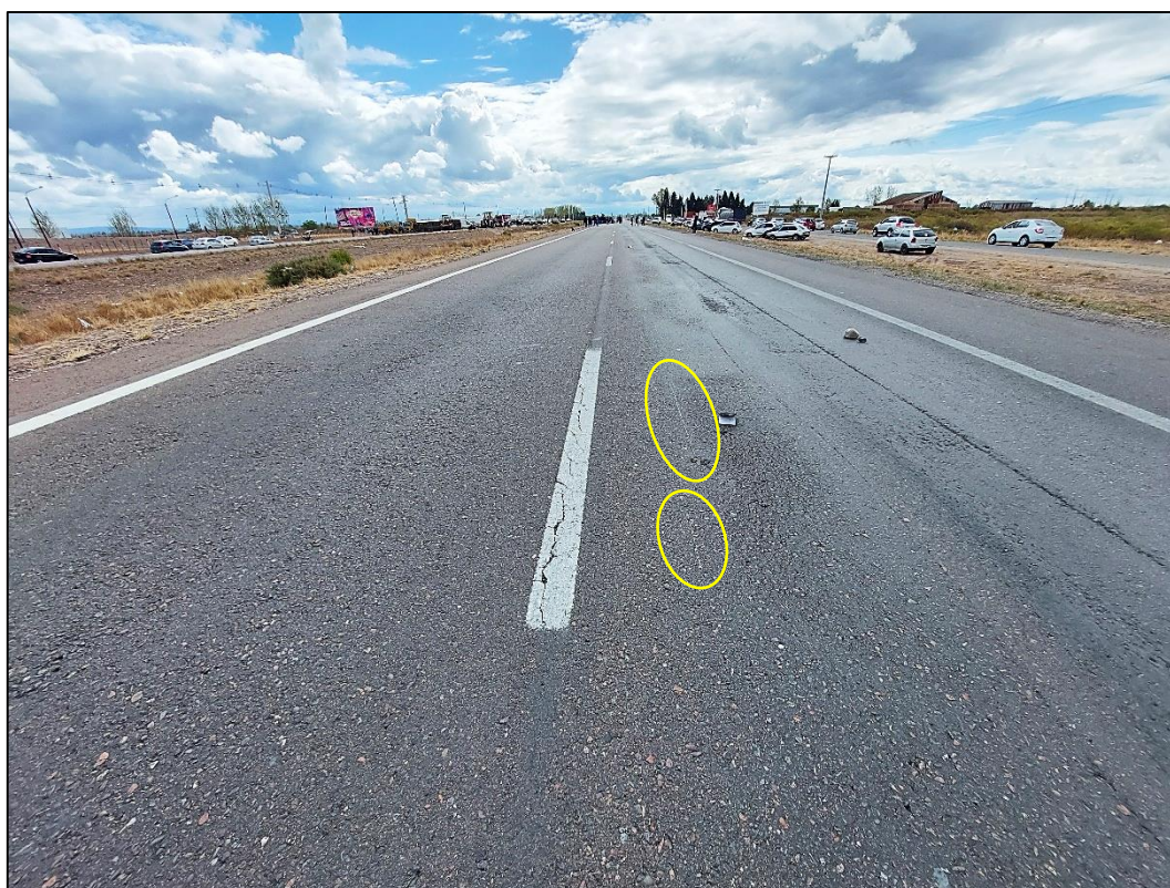
Figura 6. Vista general de RN 7 en sentido hacia Ciudad de Mendoza (este a oeste). Próximo a línea blanca intermitente separador de carriles, se observan sobre la calzada dos abrasiones longitudinales a la vía con una extensión total de 2,2 metros. Fuente: JST, 2022
