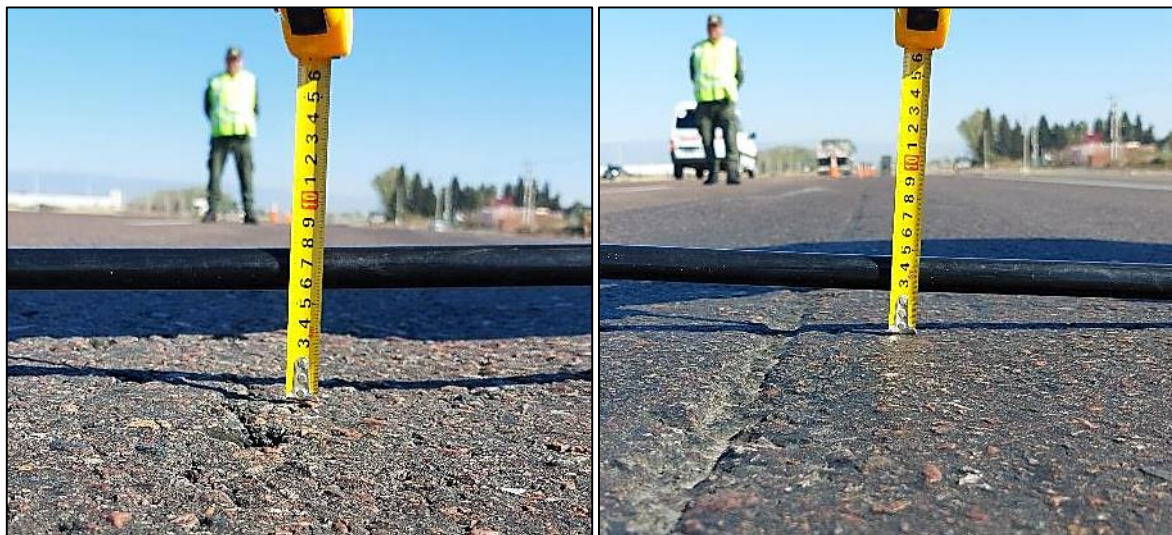
Figura 5. Fotografía tomada dos días después del suceso. Ahuellamiento sobre el carril norte, mano hacia Ciudad de Mendoza (este a oeste). Fuente: JST, 2022
