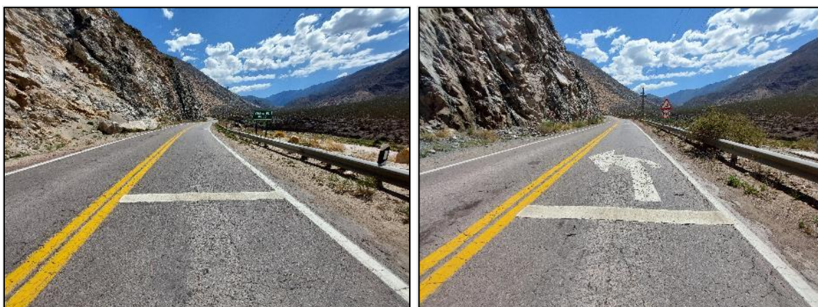
Figura 3. Ruta Nacional 7, mano hacia Chile. Se observan fallas sobre la calzada con bandas auxiliares de reducción de velocidad y flecha curva demarcada. Sobre el margen derecho: hito de arista, cartel informativo “curva de Guido” y cartel preventivo compuesto: curva inclinada y velocidad máxima 60 km/h. Fuente: JST, 2023
