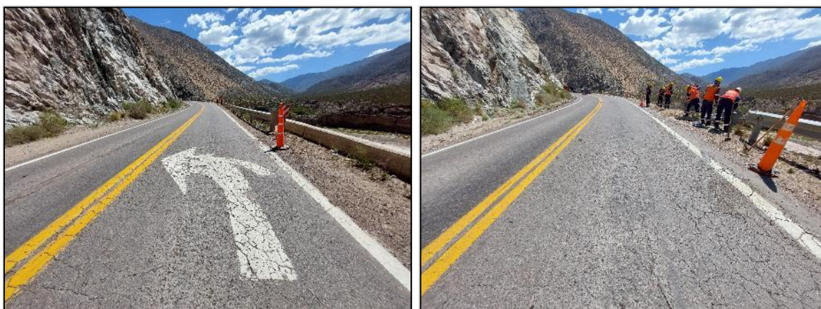
Figura 4. Tramo previo al inicio de la curva de Guido, mano hacia Chile. A la derecha se observa personal de Vialidad Nacional en tareas de reacondicionamiento de defensas laterales posoccidente. Fuente: JST, 2023
