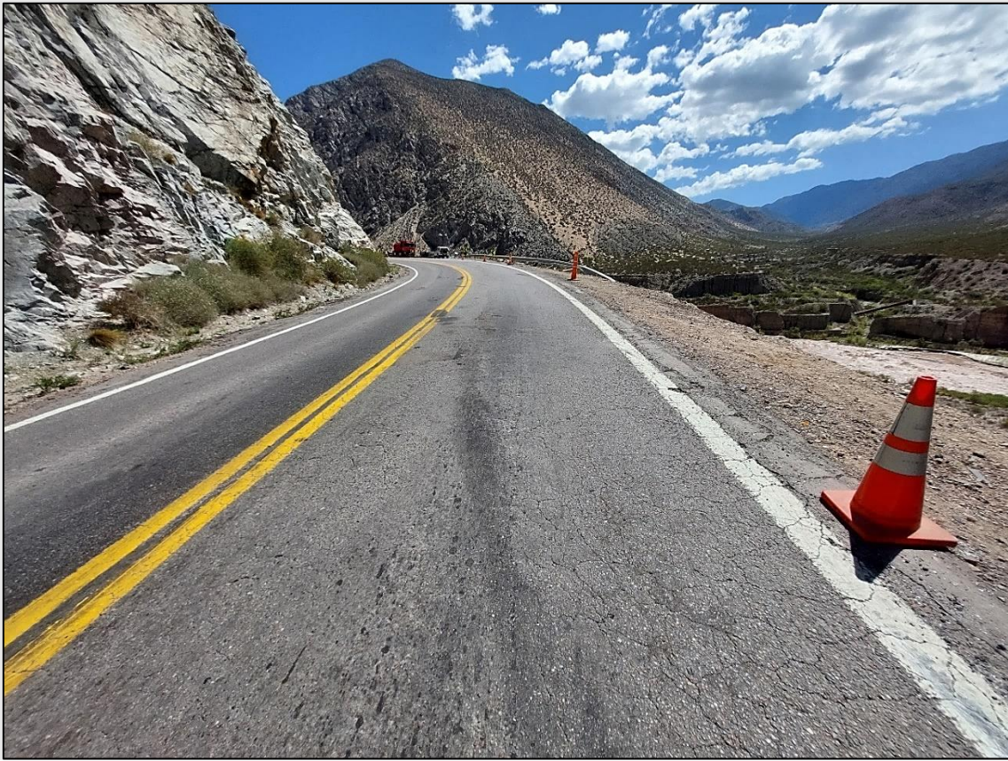
Figura 5. Tramo de curva, mano hacia Chile. A la derecha se observa el faltante de las defensas laterales, lugar de despeñamiento vehicular. Fuente: JST, 2023
