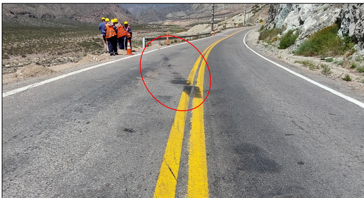
Figura 21. Sobre la doble línea amarilla y el carril externo de la curva, se observan manchas de fluidos vehiculares recientes. Fuente: JST, 2023
