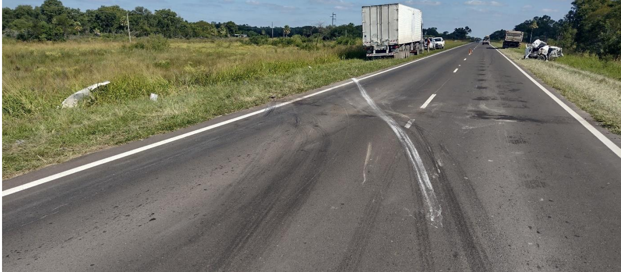
Figura 23. Vista de la proyección de las marcas de neumático y efracciones cruzando el carril de circulación contrario con dirección hacia la banquina opuesta. Fuente: JST, 2023
