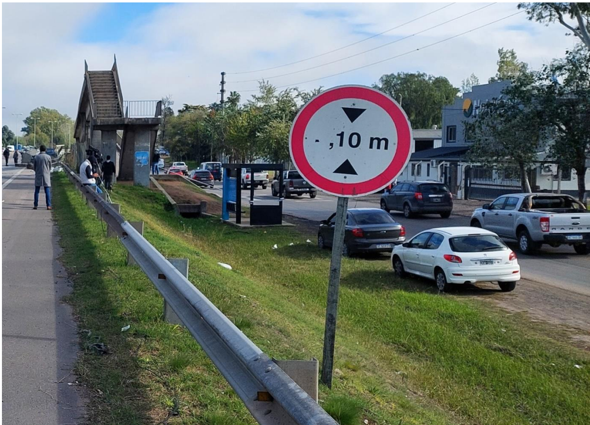
Figura 5. Señalización vertical de altura máxima despintada, previa al puente impactado. Fuente JST, 2023
