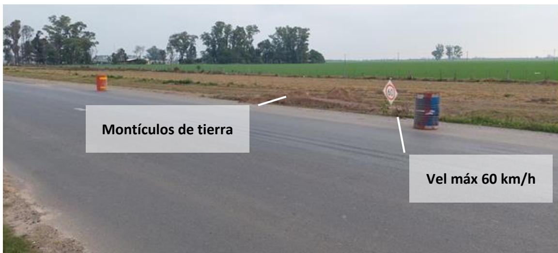
Figura 7. Detalle de señal reglamentaria y montículos de tierra. Fuente: JST, 2023
