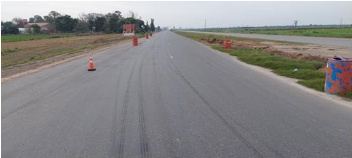
Figura 11. Marcas de neumáticos en la zona de estrechamiento de calzada. Fuente: JST, 2023
