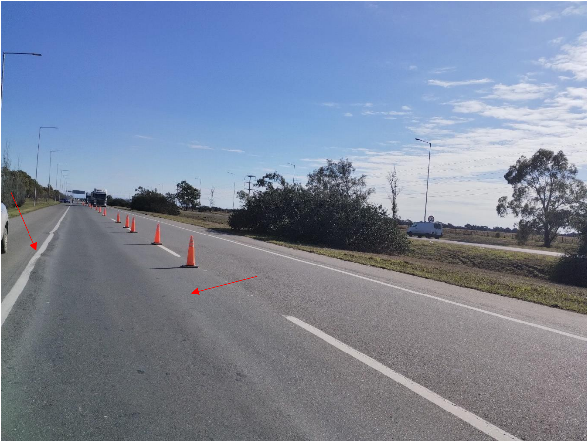
Figura 6. Ahuellamiento y deformación de la calzada. Fuente: JST, 2023
