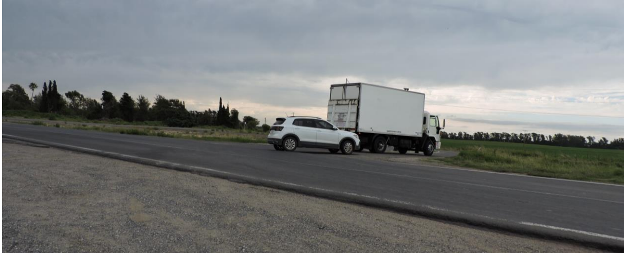
Figura 7. Señalización horizontal de la RN 8. Línea de borde de carril despintada en sectores. Vista hacia la RN 36. Fuente: JST, 2024
