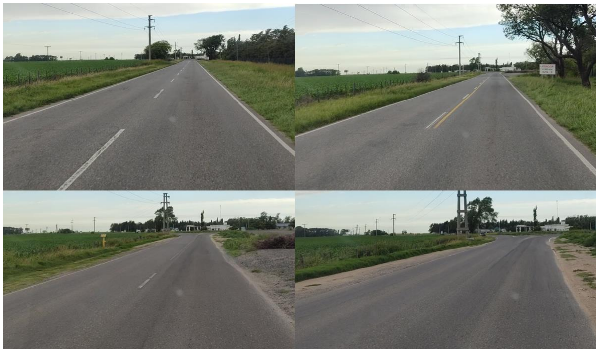
Figura 4. Vista con sentido de avance del Vehículo 1. Señalización horizontal de la RN 36 previa al ingreso de la intersección. Tramos despintados y ausentes. Fuente: JST, 2024
