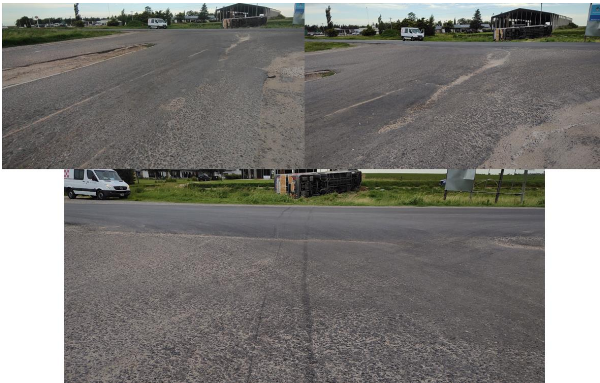
Figura 6. Vista desde la RN 36 hacia la RN 8. Desniveles, baches y desintegración de bordes.
