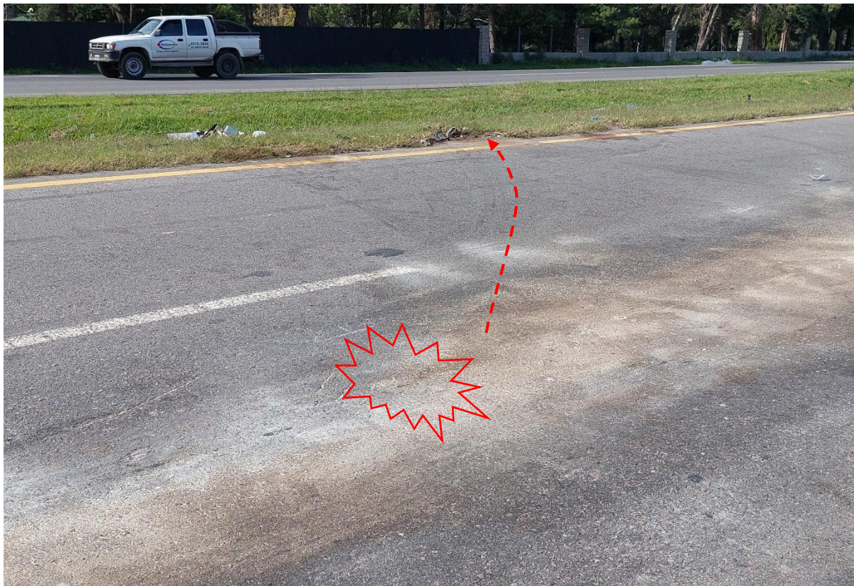
Figura 26. Zona de colisión y huella de roto traslación posimpacto del Vehículo 1. Fuente: JST, 2024
