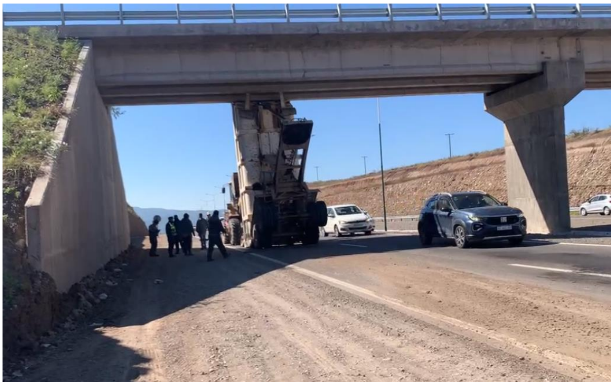
Figura 1. Posición final del semirremolque del camión luego del choque contra el puente. Fuente: Página de Facebook de diario digital Que Pasa Salta , 2024
