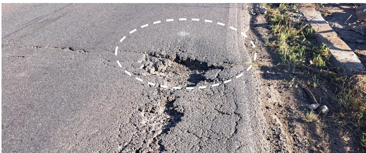
Figura 13. En la imagen se muestran las marcas de fricción de neumático observadas a partir del bache situado sobre el carril ascendente de la ruta. Fuente: JST, 2024
