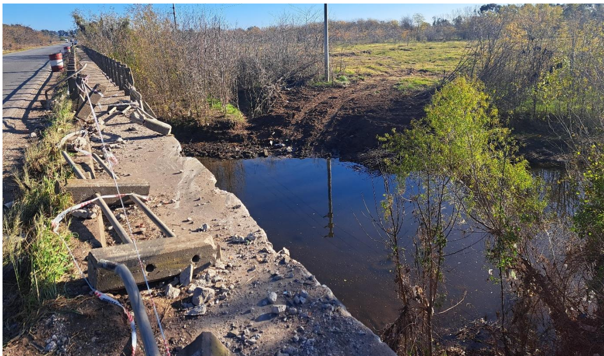
Figura 16. Vista de las marcas de fricción y daños del paso peatonal y baranda del puente en el área donde el conjunto cayó al cauce del río Luján. Fuente: JST, 2024
