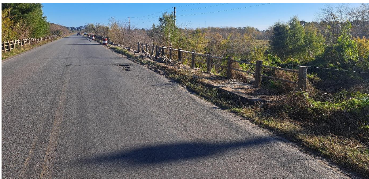
Figura 5. En la imagen se pueden ver los daños observados en las barandas del puente peatonal del lado contiguo al carril ascendente de la ruta. Fuente: JST 2024
