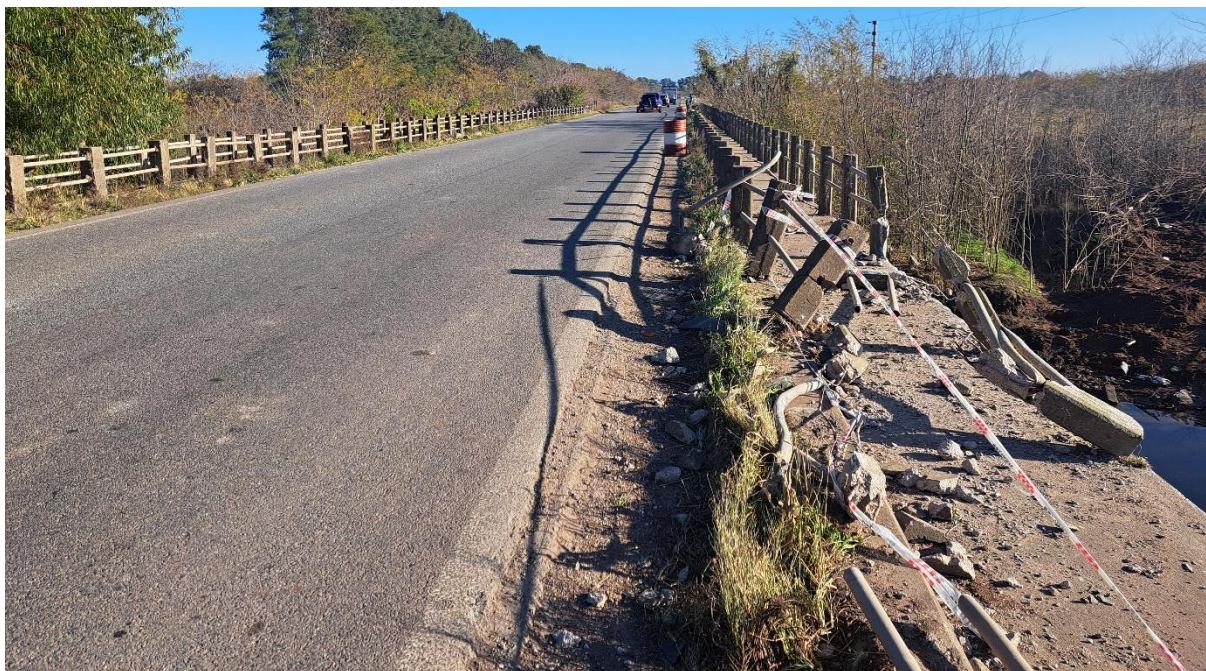
Figura 12. En la imagen se muestra la cinta de seguridad que fue colocada en la zona de las barandas dañadas. Fuente: JST, 2024
