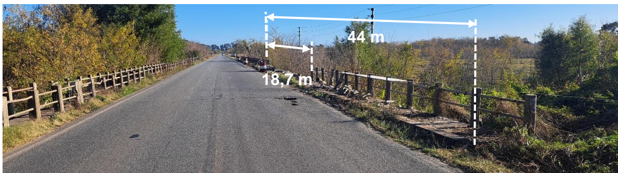
Figura 11. Vista y señalamiento de los daños en las barandas del puente peatonal. Fuente: JST,2024
