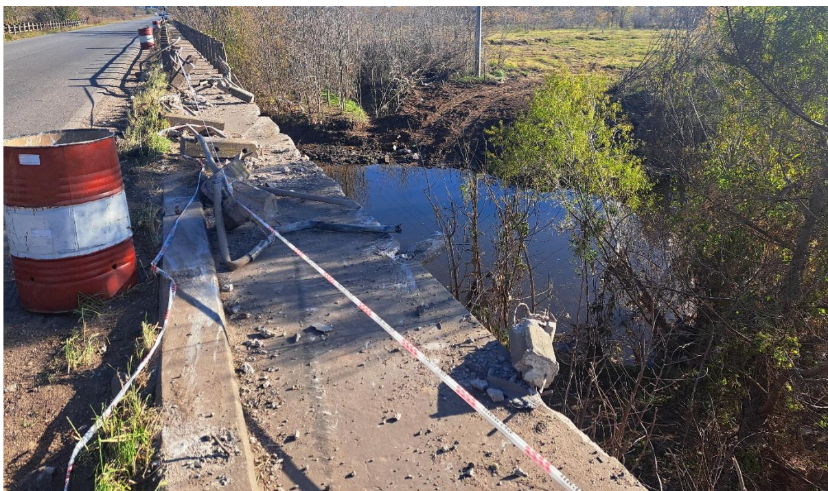
Figura 15. En la imagen se pueden ver las marcas de neumático y de fricción producidas por la unidad sobre la vereda del puente peatonal. Fuente: JST, 2024
