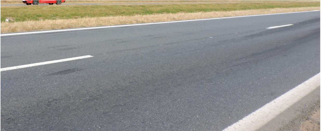
Figura 9. Marca de neumático sobre el carril de circulación pre-impacto de los vehículos. Inicio de marcas dinámicas de fluido. Fuente: JST, 2024
