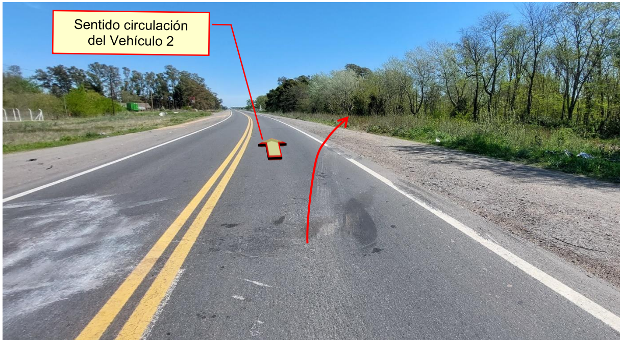
Figura 19. Inicio de la huella posimpacto del Vehículo 2. Fuente: JST, 2024
