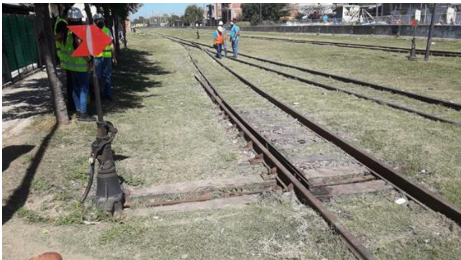
Figura 3 - Mecanismo de accionamiento e indicación de la posición de la trampa del suceso al 26/02/2021
