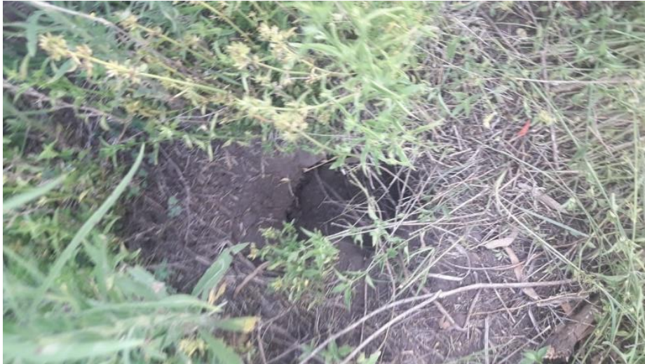
Figura 5. Orificio en el balasto de la superestructura. Fuente: JST, 2021
