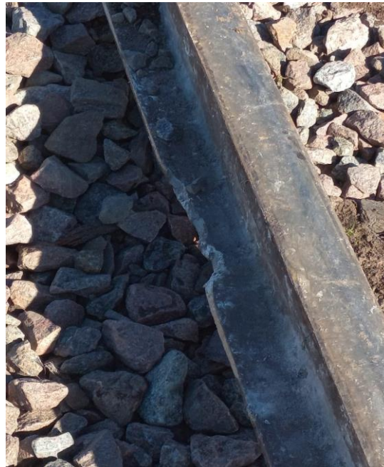
Figura 17. Marcas en el patín del riel a la altura del descarrilamiento. Fuente: JST, 2021
