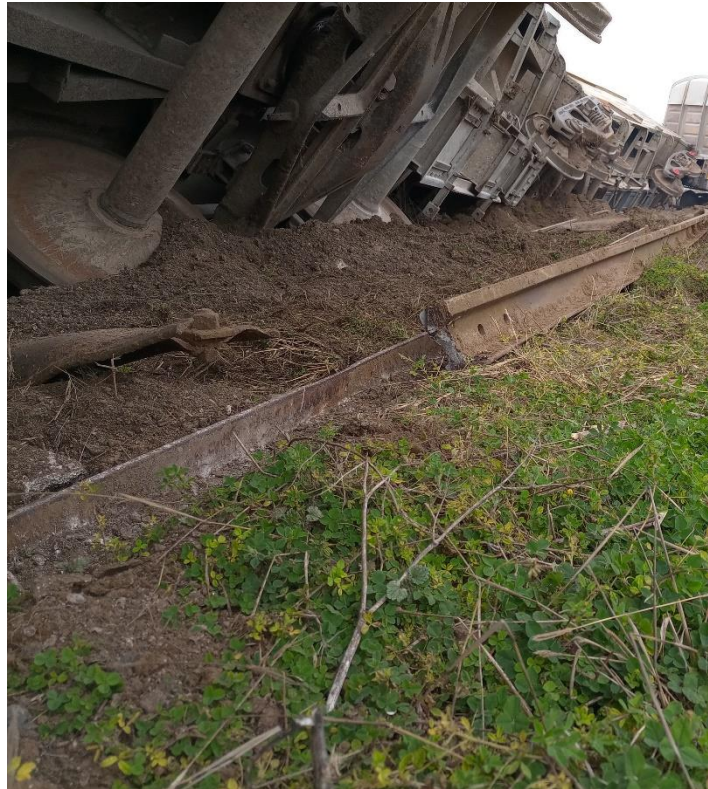
Figura 15. Vista del riel volcado y fracturado a altura del vagón N° 638452. Fuente: JST, 2021
