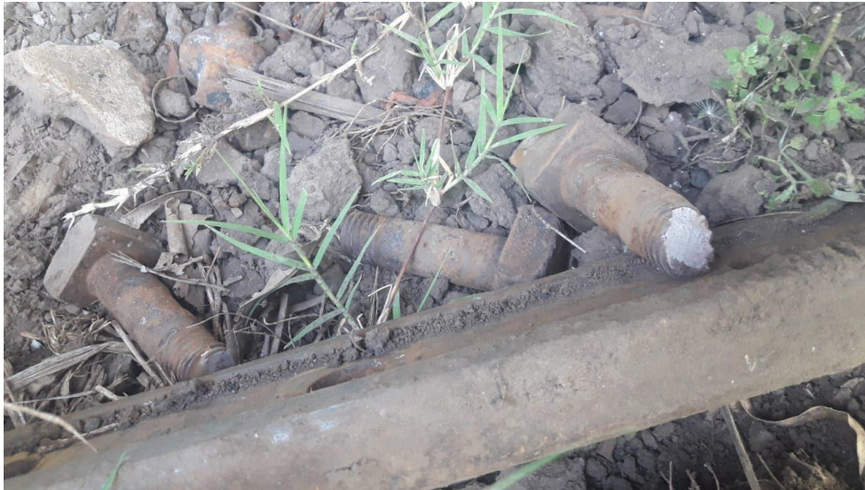
Figura 13. Bulones de eclisas fracturados. Fuente: JST, 2021
