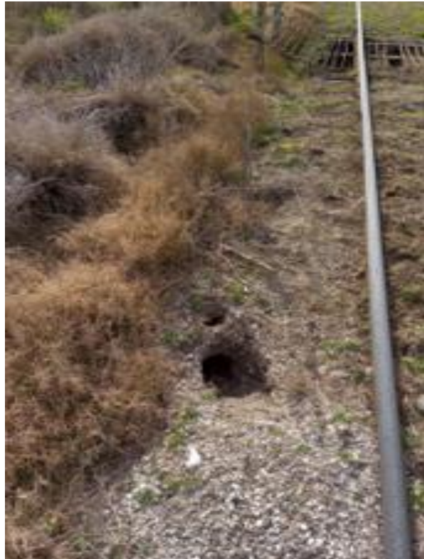
Figura 9. Pozos en terraplén de la vía. Fuente: JST, 2021
