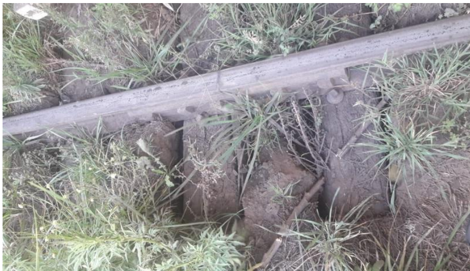
Figura 6. Vía con presencia de balasto de tierra licuado y movimiento vertical de durmientes. Fuente: JST, 2021
