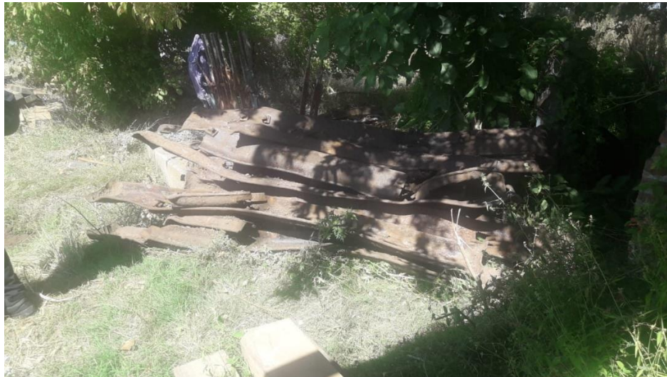
Figura 14. Durmientes metálicos deformados. Fuente: JST, 2021
