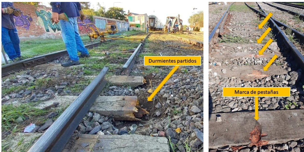
Figura 6. Estado de la superestructura de vía horas después del descarrilamiento, Fuente: Archivo JST
