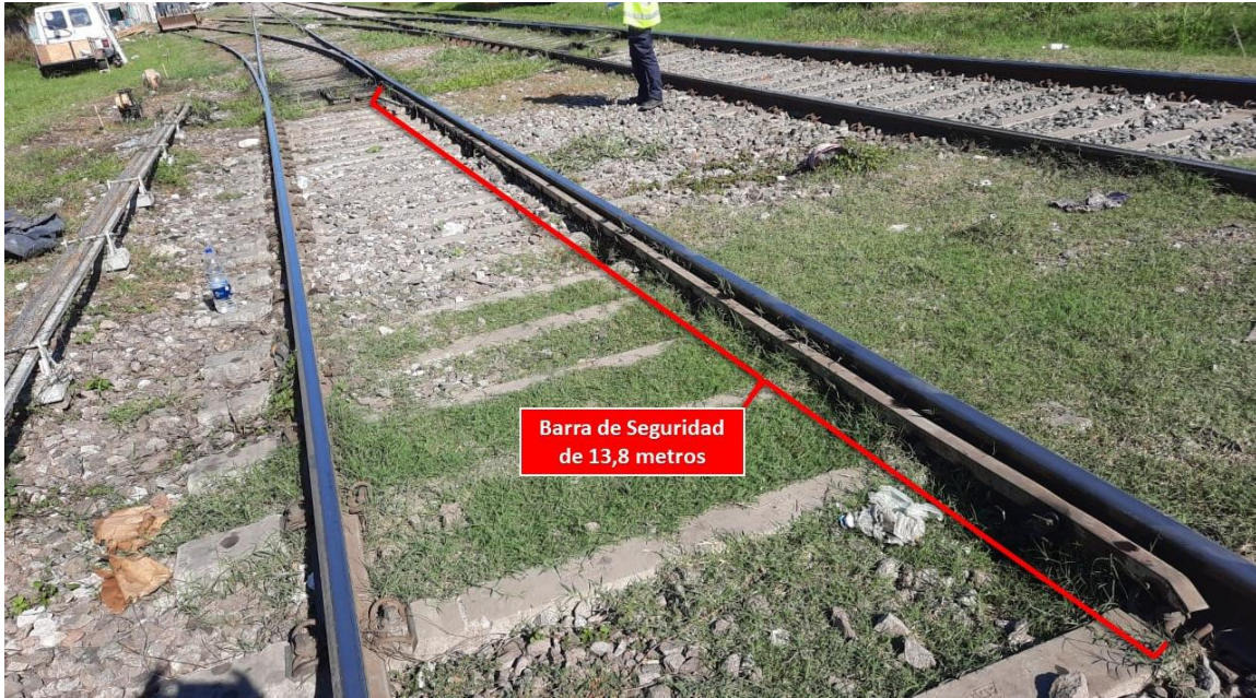
Figura 7. Medición de la barra de seguridad durante la primera visita, Fuente: Archivo JST
