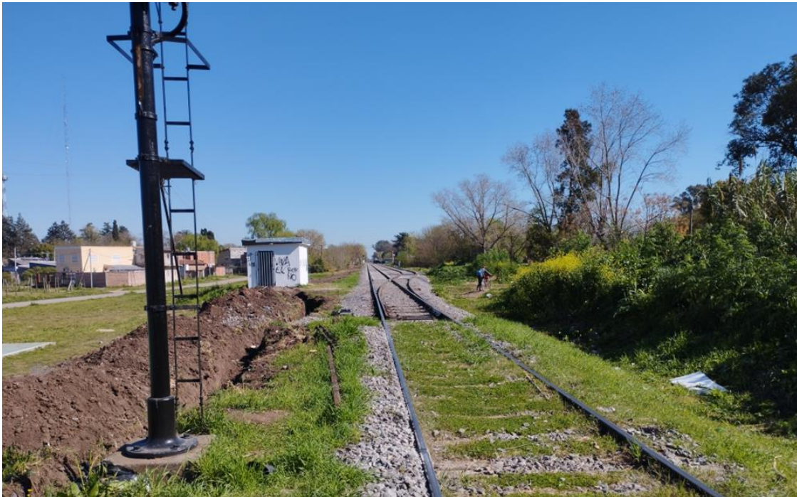
Figura 7. Límite del tramo renovado en el cuadro de estación Matheu. Fuente: JST, 2022
