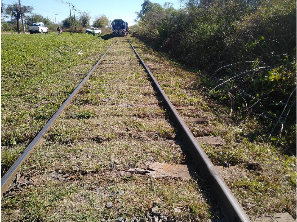
Figura 3. Superestructura de vía con presencia de balasto colmatado y crecimiento de vegetación. Fuente: JST, 2021
