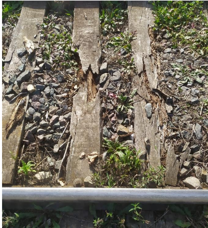
Figura 5. Durmientes deteriorados. Fuente: JST, 2021
