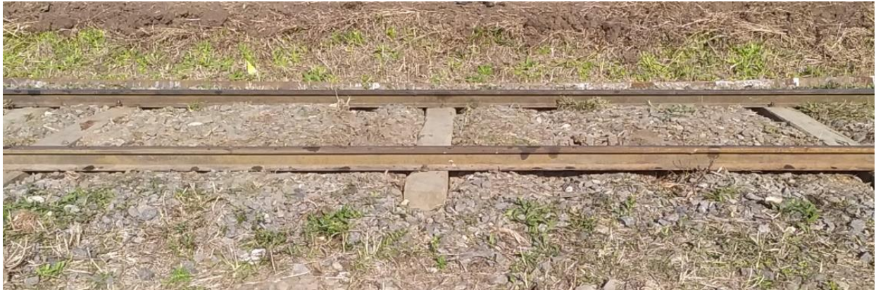
Figura 4. Tramos de vía con faltantes de durmientes. Fuente: JST, 2021
