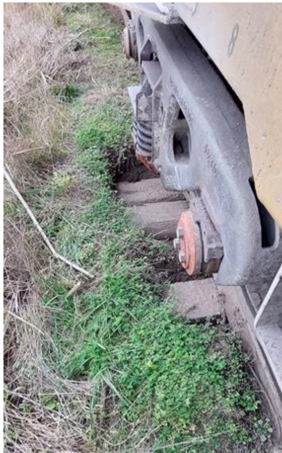
Figura 5. Asentamiento de durmientes bajo vagón N° 840868 en tierra húmeda. Fuente: investigadores JST
