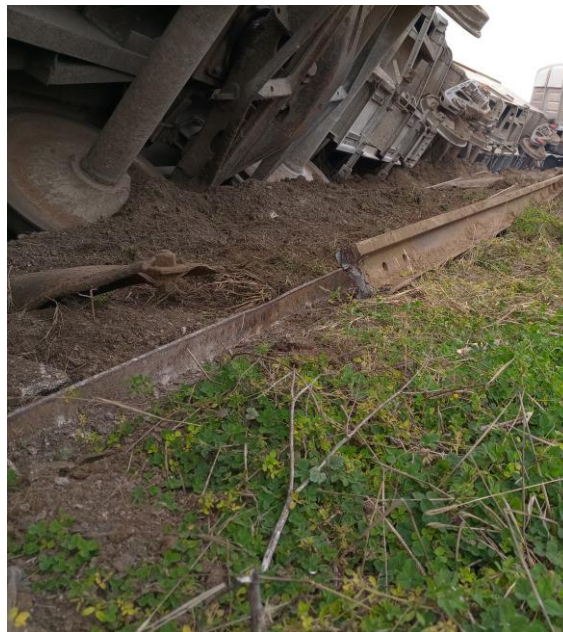
Figura 9. Vuelco de riel y fractura de soldadura a altura de vagón N° 638452
