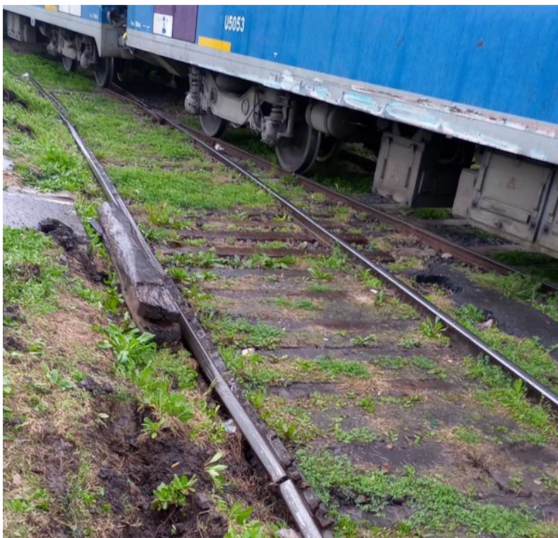
Figura 8. Vuelco del riel opuesto al choque. Fuente: JST, 2021
