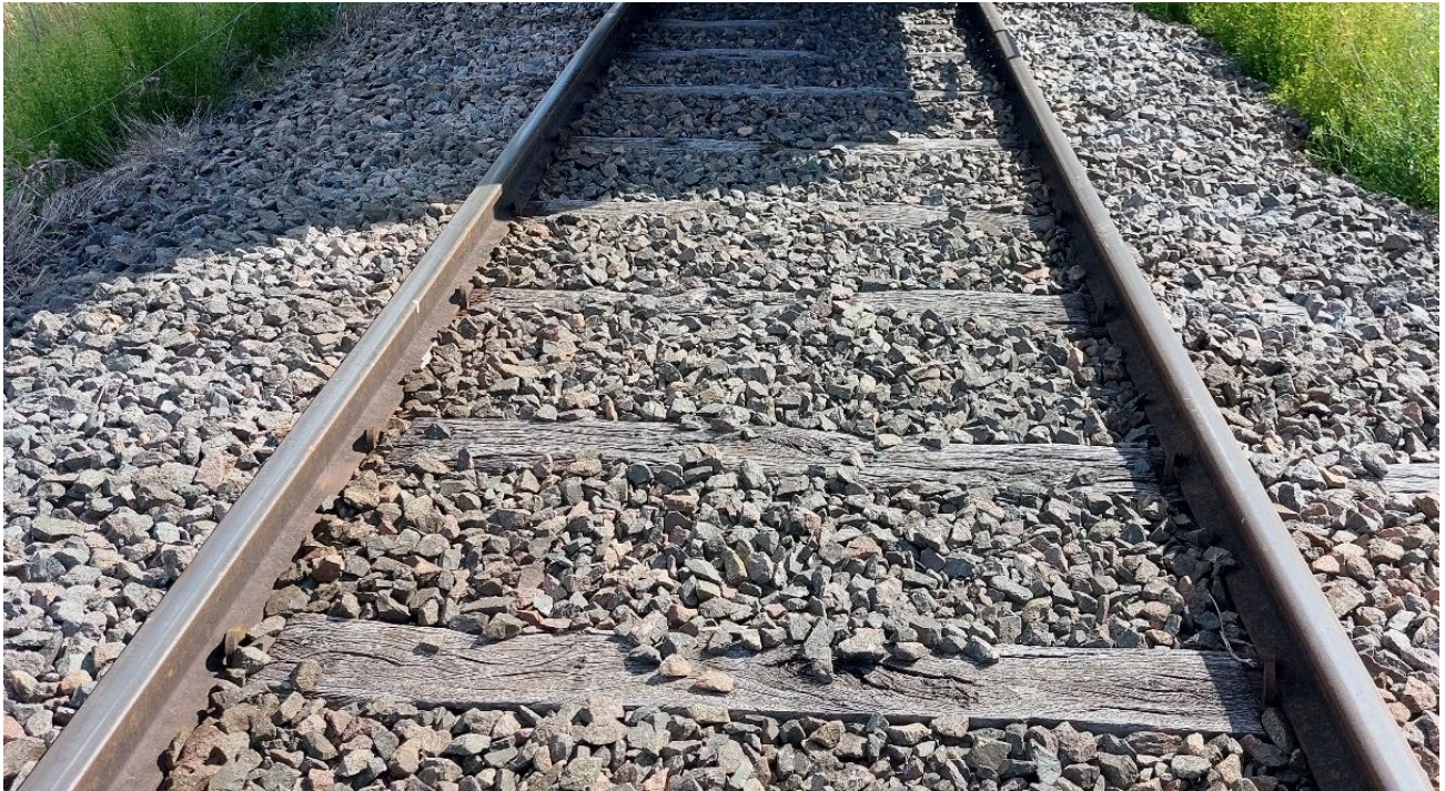
Figura 6. Superestructura de vía previa al lugar del descarrilamiento. Fuente: JST, 2022
