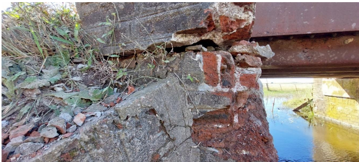
Figura 8. Alcantarilla afectada por el descarrilamiento. Fuente: JST, 2022
