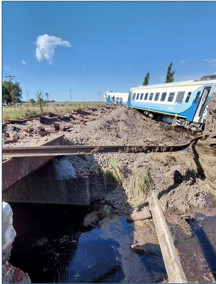
Figura 11. Superestructura destruida luego del accidente. Fuente: JST 2022
