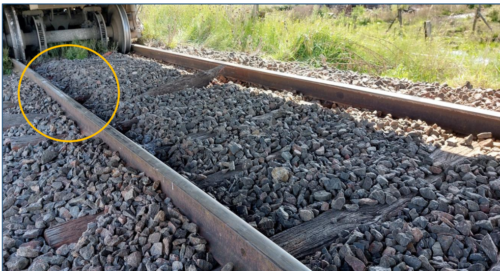
Figura 13. Marcas de pestañas sobre el hongo del riel, debajo del coche CPA 014. Fuente: JST, 2022
