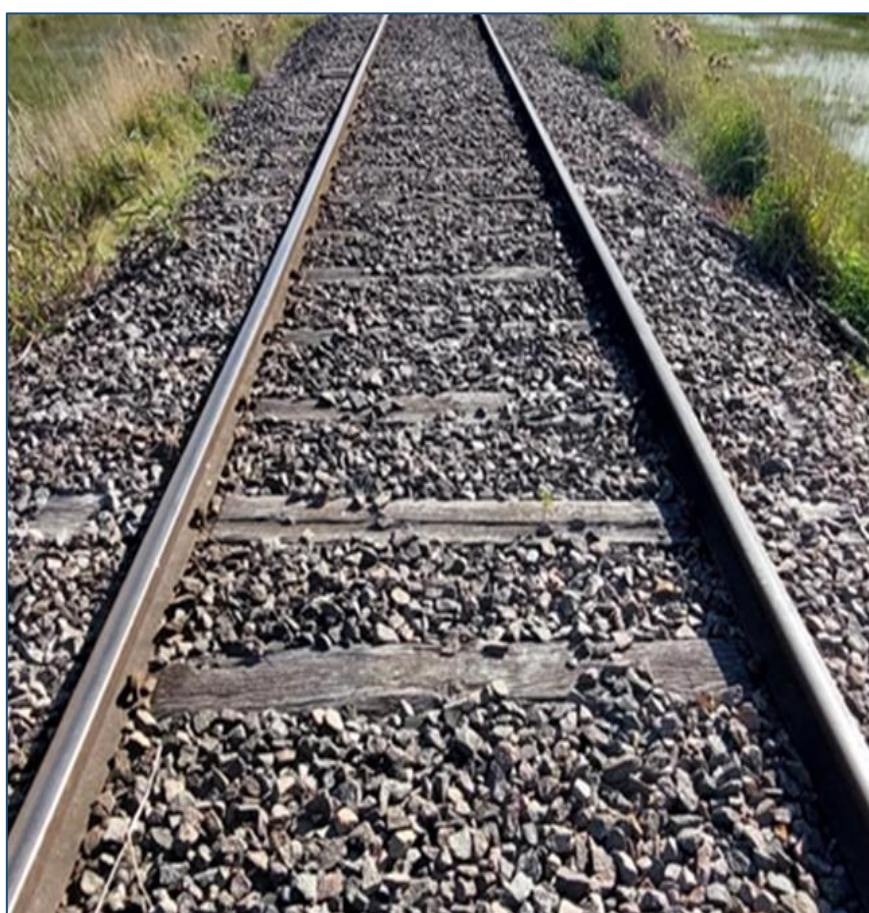
Figura 9. Tramo de vía posterior a la zona del descarrilamiento. Fuente: JST, 2022
