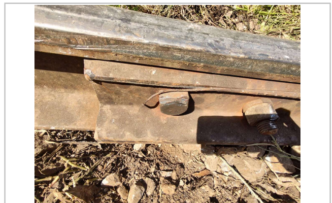
Fig.4. Eclisas afectadas por el descarrilamiento. Fte: JST
