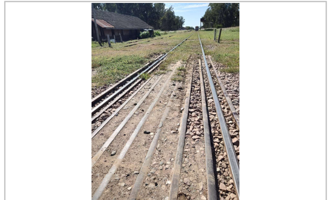
Fig. 2. Vista del PAN afectado. Fte: JST
