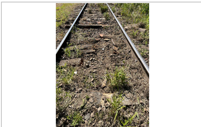
Fig. 3. Tramo de vía afectado. Fte: JST
