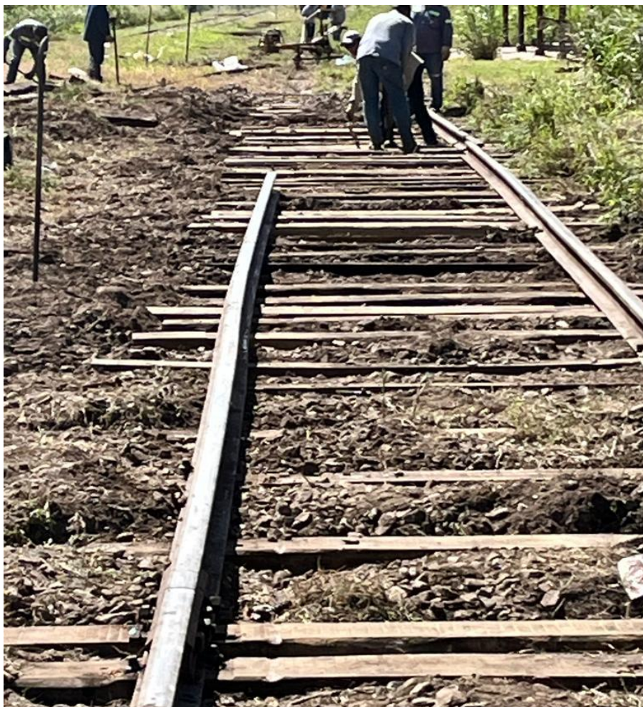
Figura 4. Tramo de infraestructura afectada por el suceso. Fuente: JST, 2022
