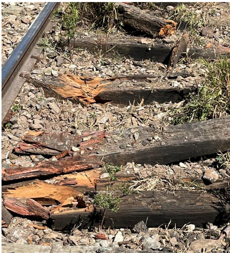
Figura 3. Daños en durmientes. Fuente: JST, 2022
