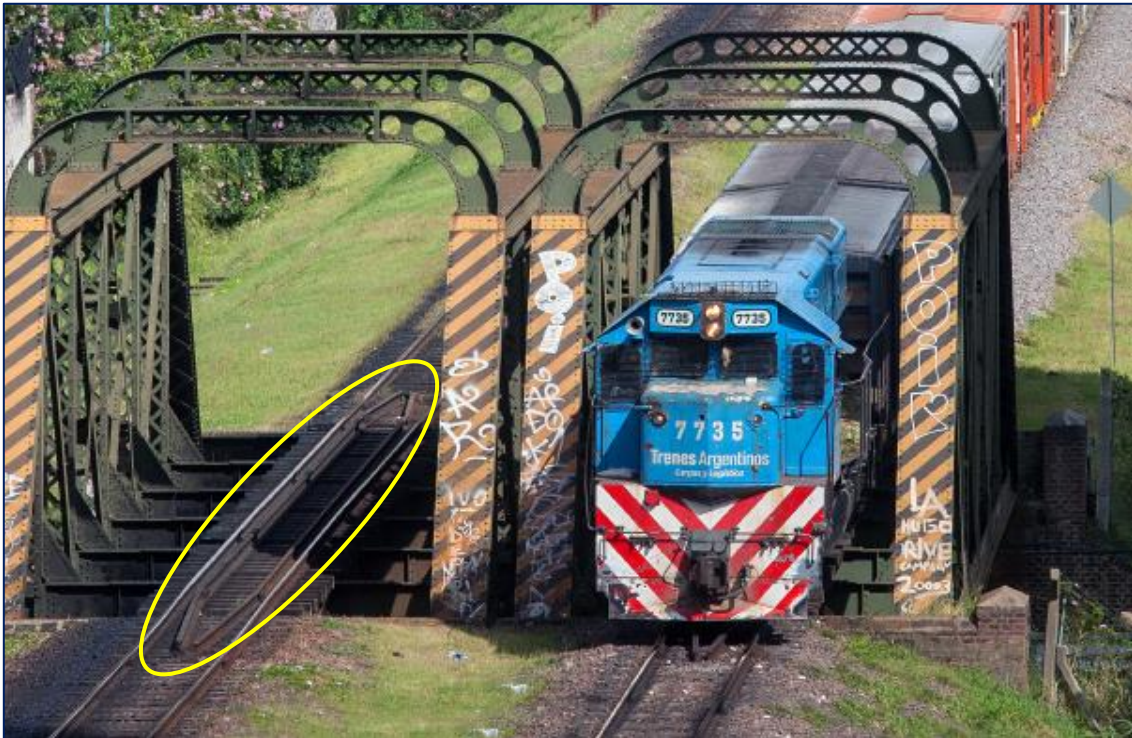
Figura 13. Contrarrieles interiores en los puentes cercanos a la estación Aristóbulo del Valle, Buenos Aires. Fuente: Railpictures.net , 2024
