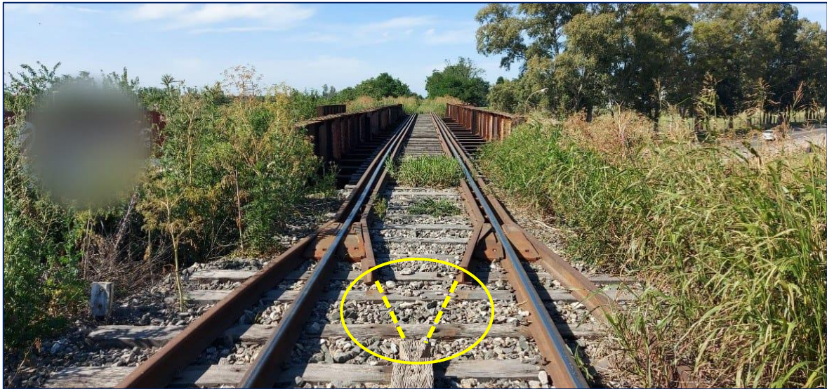
Figura 4. Estado del puente ferroviario de Pérez a un año del suceso. En la imagen se observa la instalación del sistema de contención de descarrilamientos, aunque se denota la ausencia de elementos en sus contrarrieles internos (línea punteada). Fuente: JST, 2023.
