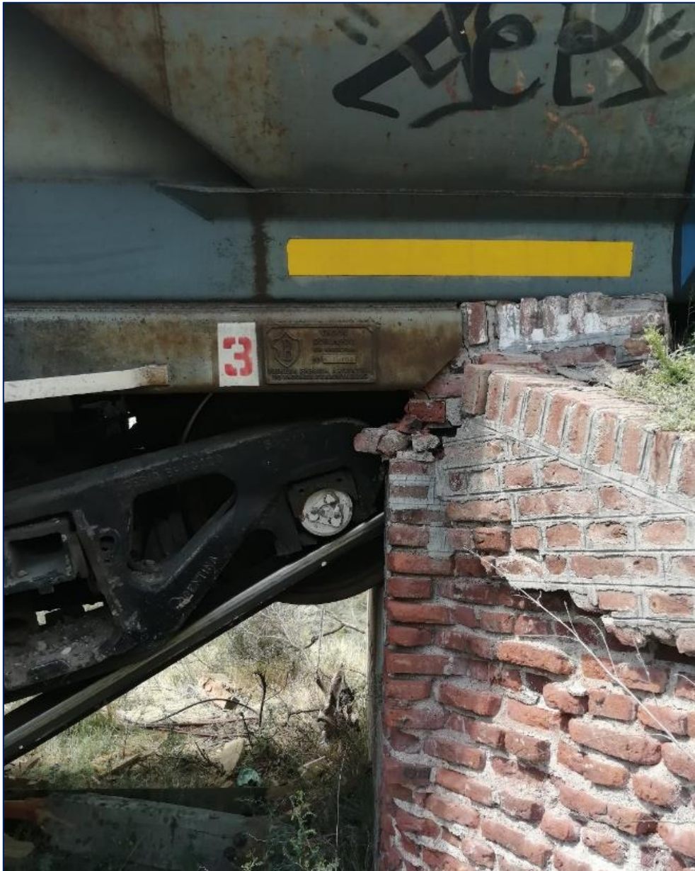
Figura 7. Vagón del tren 401/343 impactado contra la mampostería de la obra de arte.
