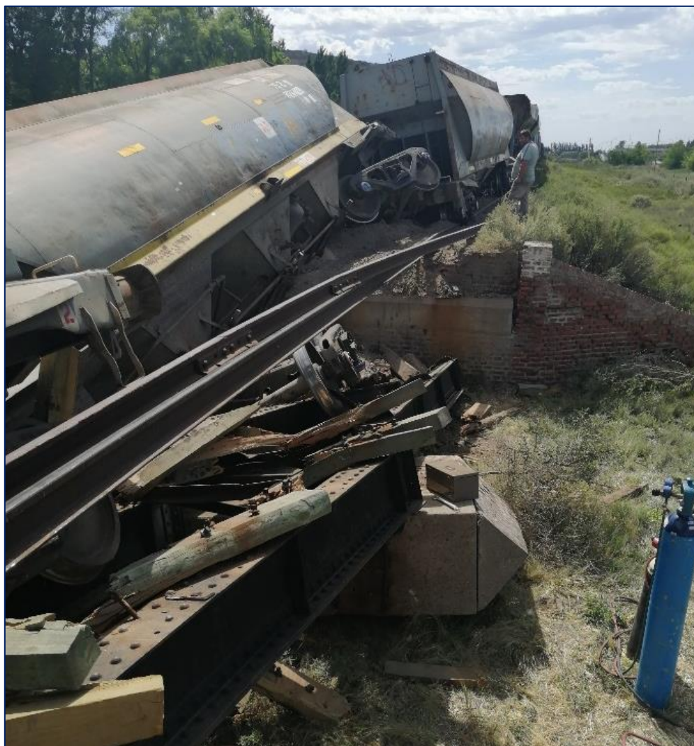
Figura 6. Daños en el puente ferroviario ocasionados por el descarrilamiento del tren 401/343.
