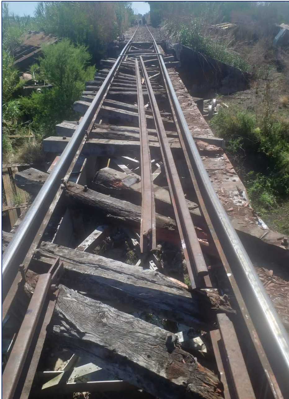
Figura 11. Daños en la obra de arte que cruza el Arroyo Sandoval.
