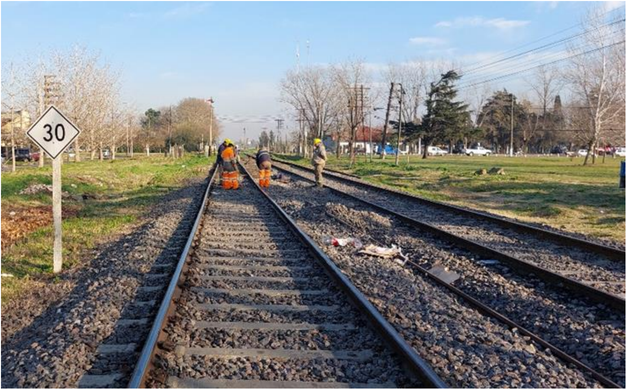
Figura 7. Precauciones en el sector afectado por el descarrilamiento. Fuente: JST, 2022
