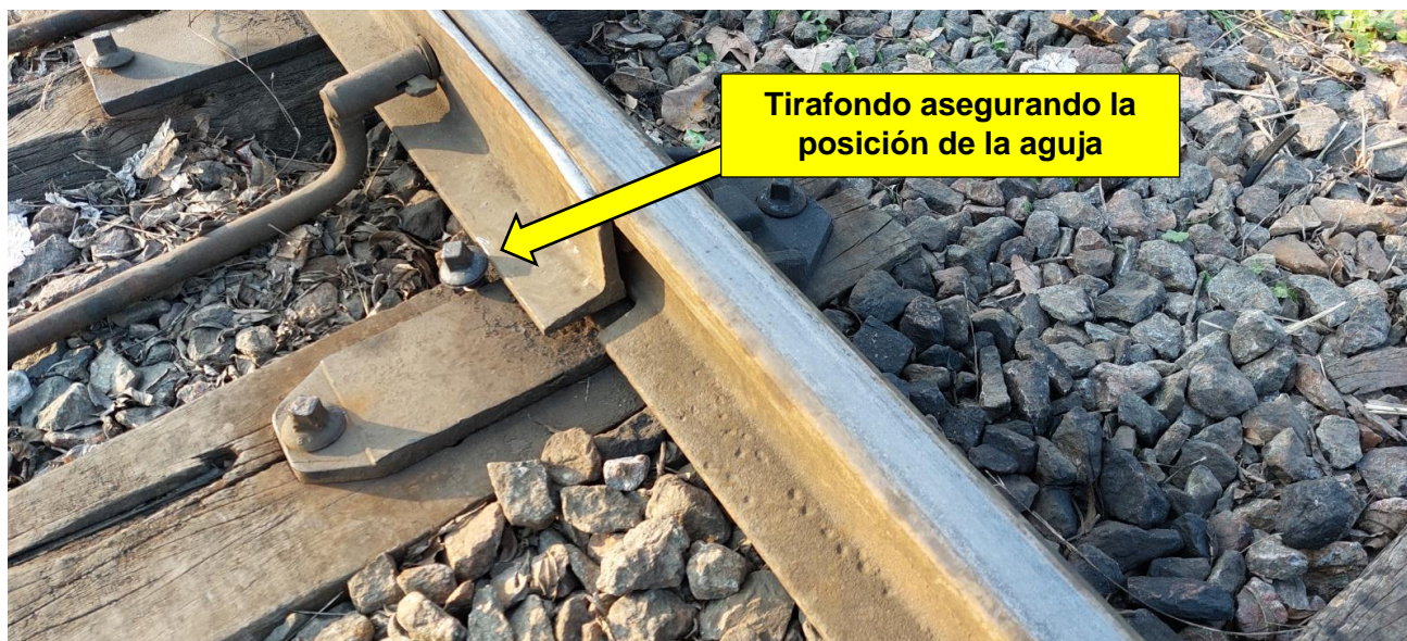
Figura 6. Aguja del ADV en sentido a la estación Moreno, asegurada con tirafondo. Fuente: JST, 2022
