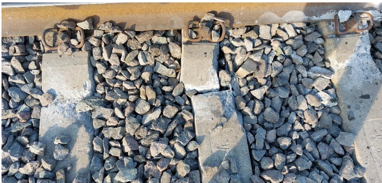
Figura 4. Durmientes de hormigón afectados por el suceso. Fuente: JST, 2022
