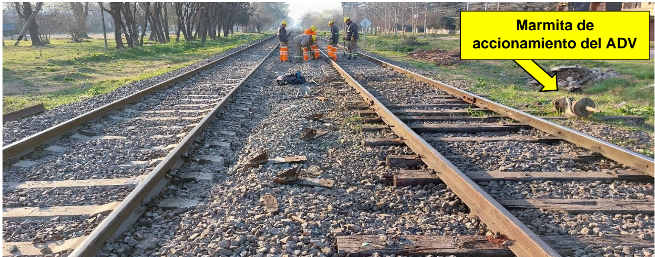
Figura 2. Diferencias de la superestructura entre la vía de corrida y el ADV. Fuente: JST, 2022
