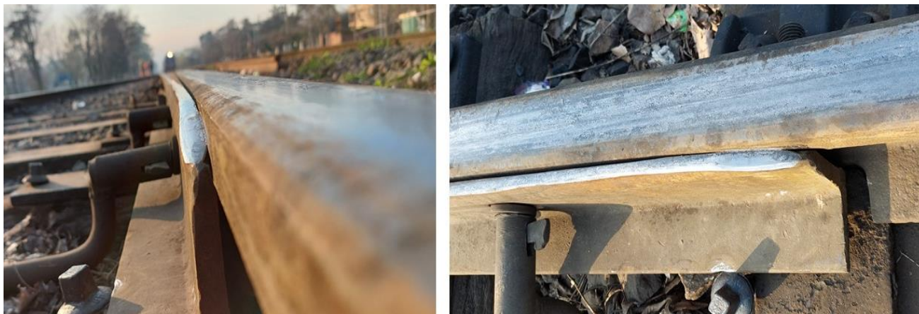
Figura 8. Aguja del ADV en sentido a la estación Moreno. Fuente: JST, 2022
